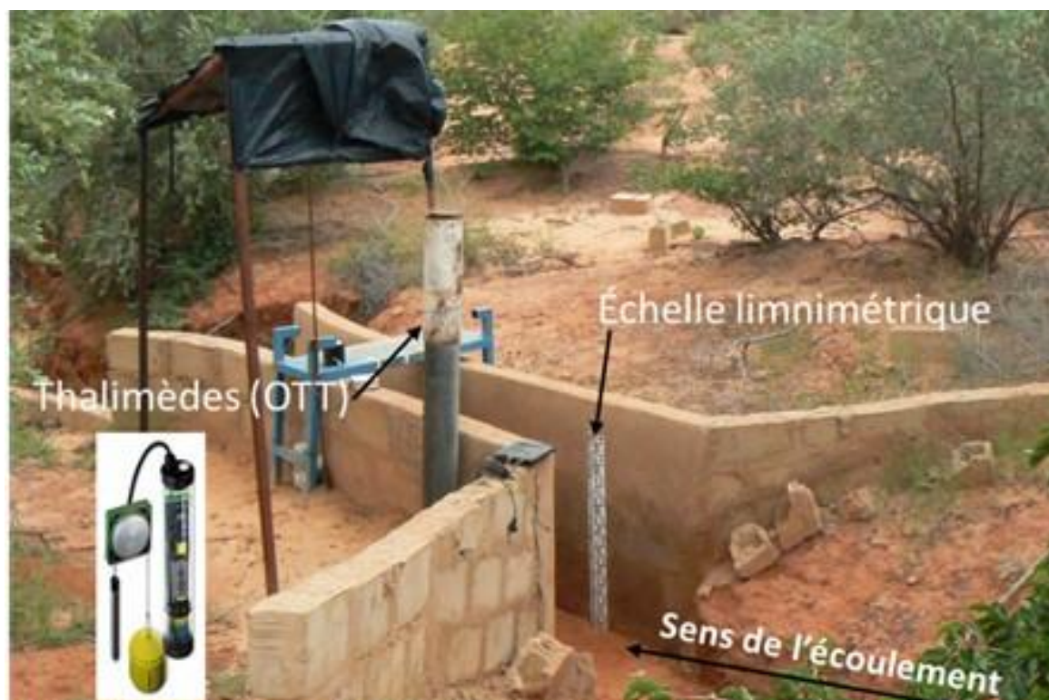
Figure 30. La station hydrométrique installée à l'exutoire du bassin versant TK-IBM.
