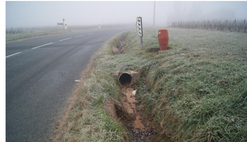
Dépôt sédimentaire dans un fossé
