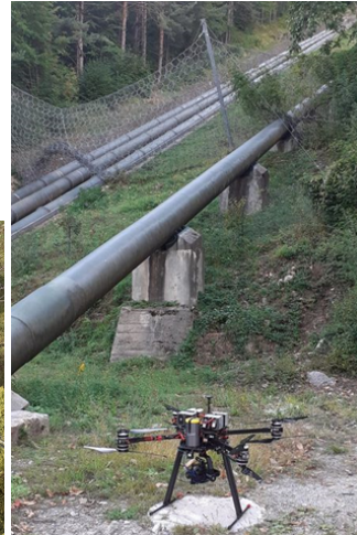
(B) Conduite d'eau (EDF)
