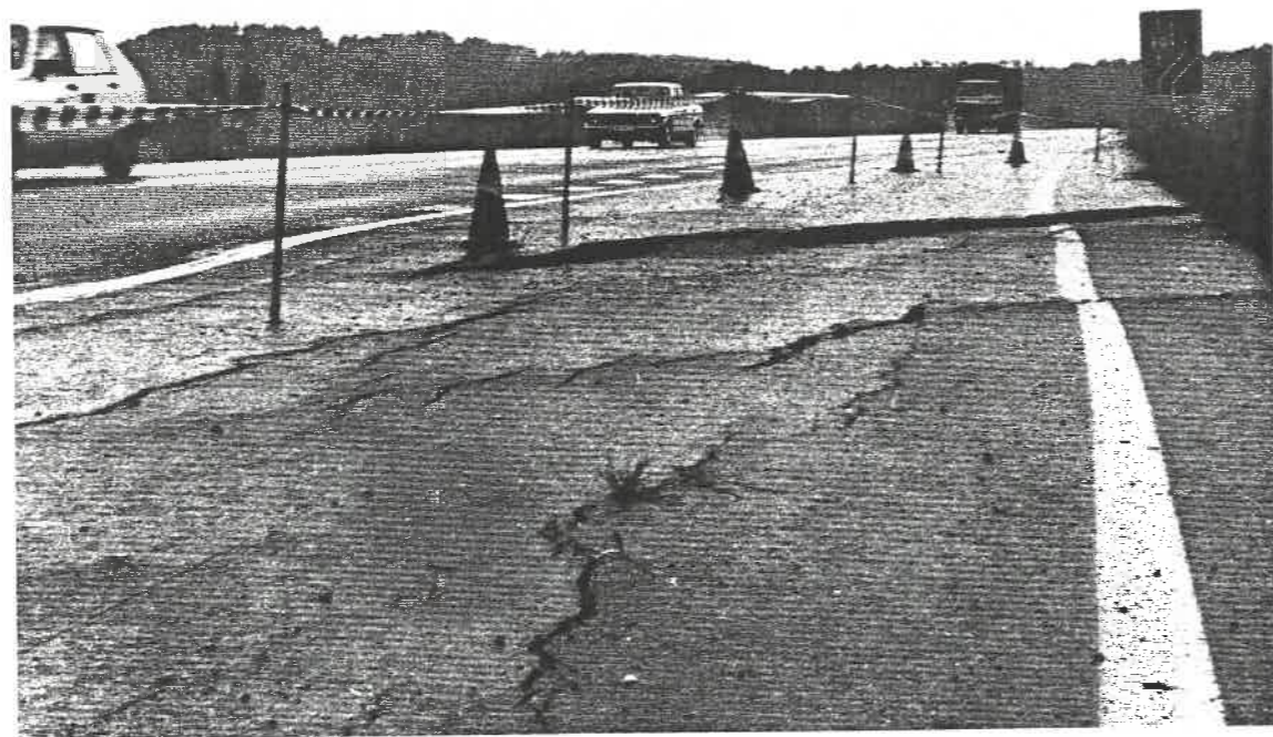
- fig. II. 11 : Effondrement par failles normales concentriques (juin 1989), sur la route 150 entre Banyoles et Besalú, au lieu dit Can Guixeres.
