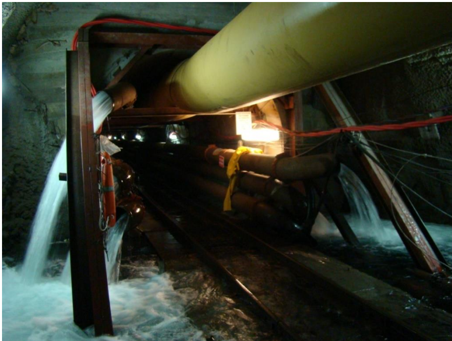
Venues d'eau au Point Métrique 3000 de la Galerie Salazie-Amont (La Réunion, 29/11/2010)
