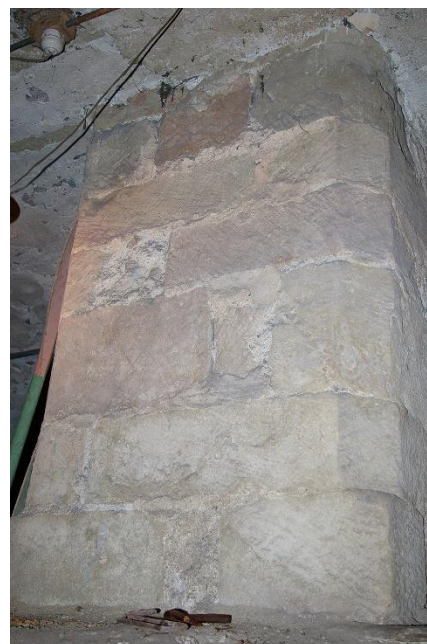
Fig. 7: Pilier de soutènement présentant un chanfrein. Cliché : C. Guffond.
