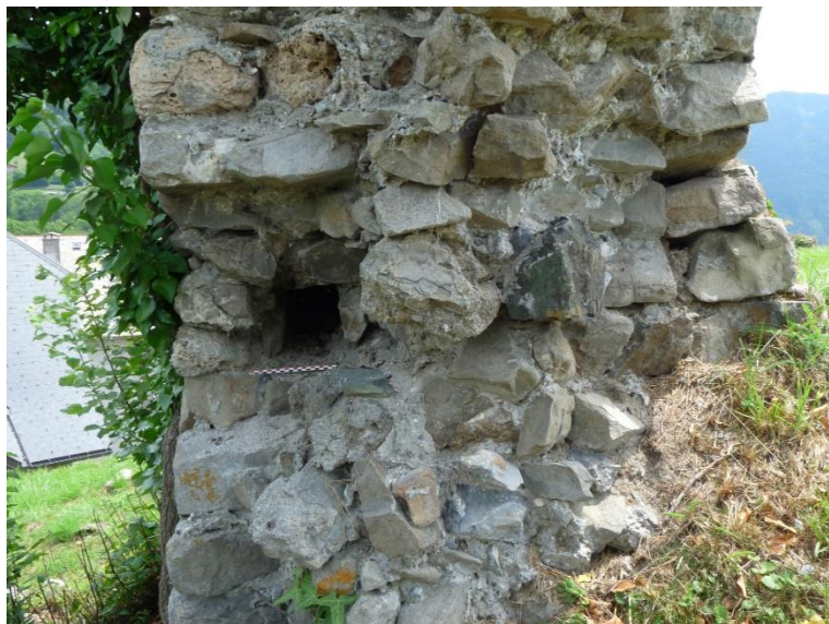
Fig. 9: Trou de poutre de fermeture dans l'une des failles du mur de logis. Cliché : A. Lorphelin.
