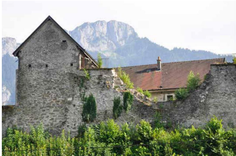
Fig. 5: Eboulement du front nord-ouest en 2013. Cliché : L. D'Agostino.
