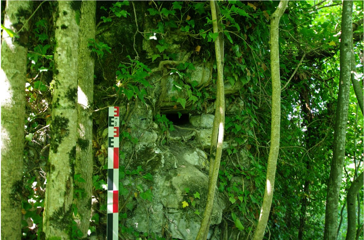
Fig. 4: Potentiel trou de poutre en lien avec une fermeture de porte. Cliché : C. Guffond.
