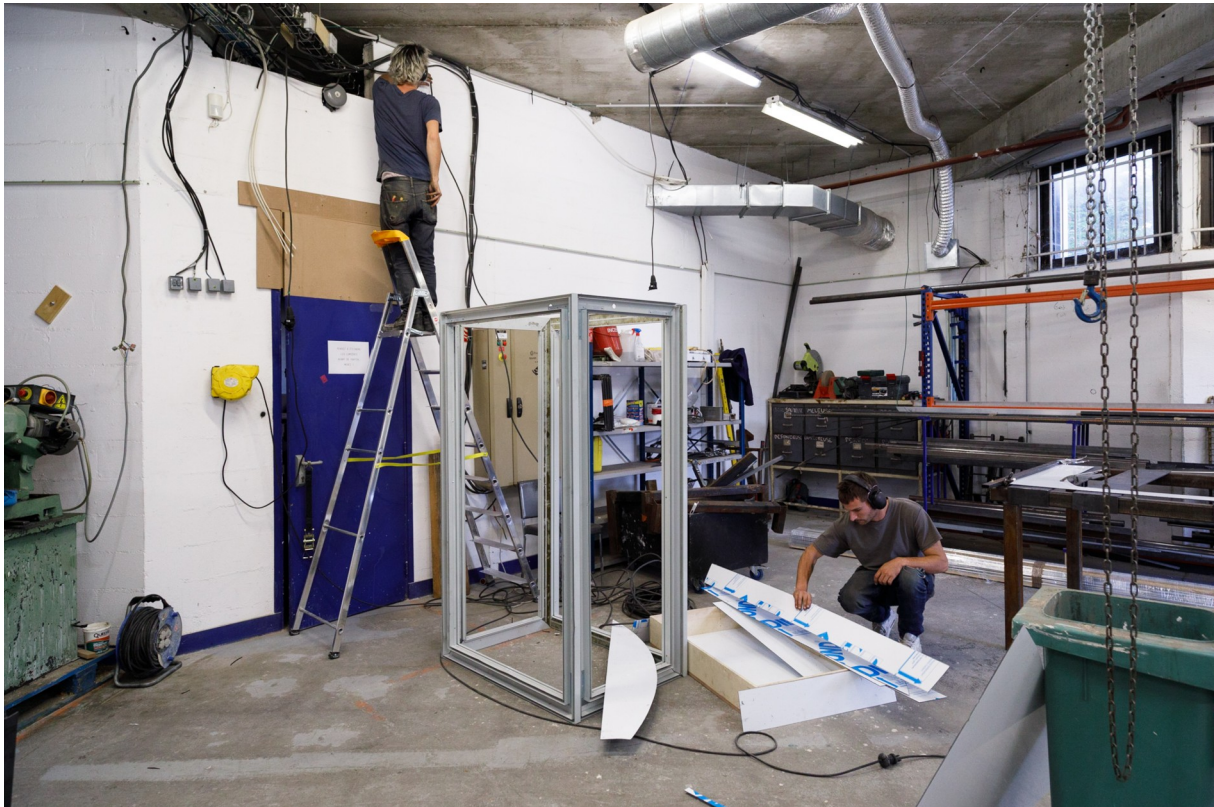
Archive photographique de Salim Santa Lucia. L'équipe des fondateur.ice.s, expérimentée, s'occupe notamment de remettre l'électricité en bonne marche, Charly étant particulièrement dédié à cette tâche.
