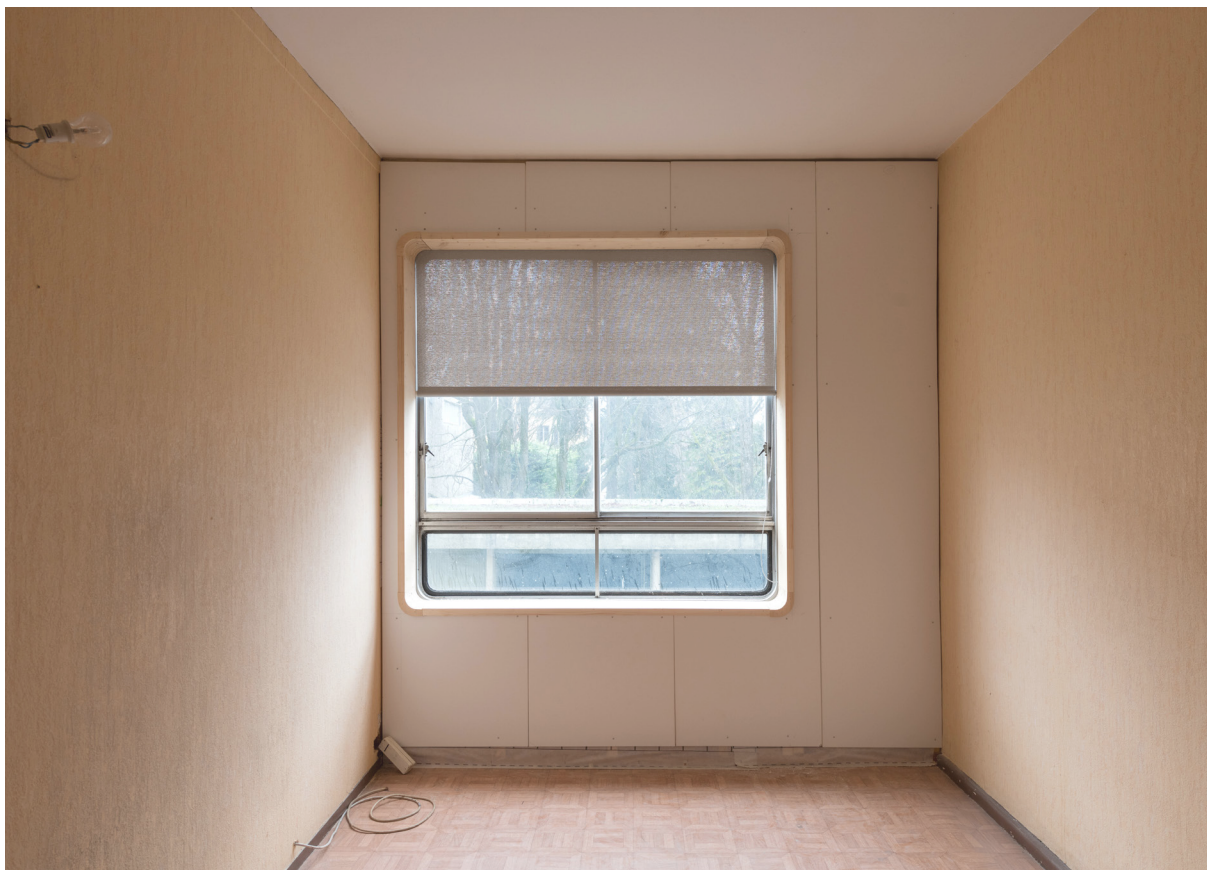
Le prototype de doublage achevé, sans la restauration de la fenêtre en double vitrage © Sabine Serrad, 28 janvier 2020
