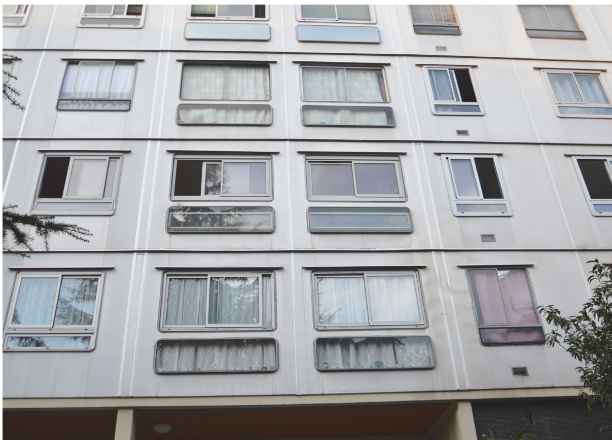
Altérations en façade © Mathilde Padilla, 2018
