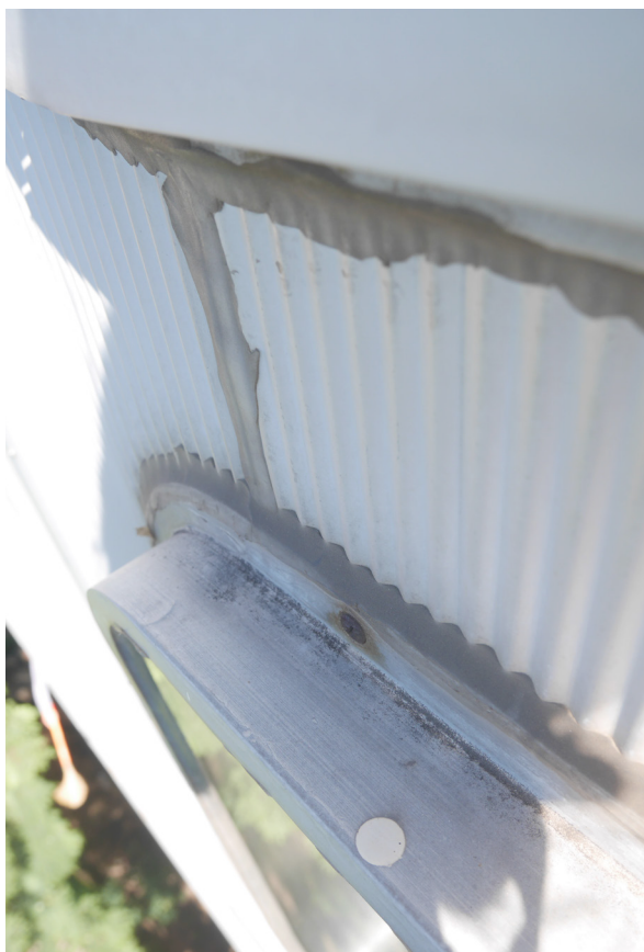
Reprise maladroite de l'étanchéité des panneaux © Mathilde Padilla, 2019
