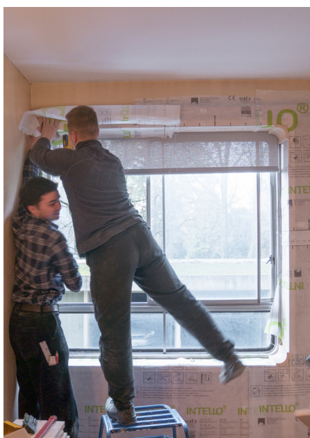
Installation de l'isolant fibre de bois et du frein-vapeur © Mathilde Padilla, 25 janvier 2020
