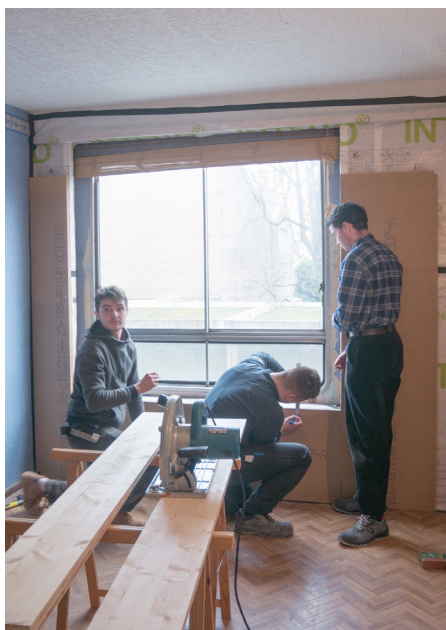
Pose de la seconde couche de fibre de bois, 4 cm © Mathilde Padilla, 25 janvier 2020
