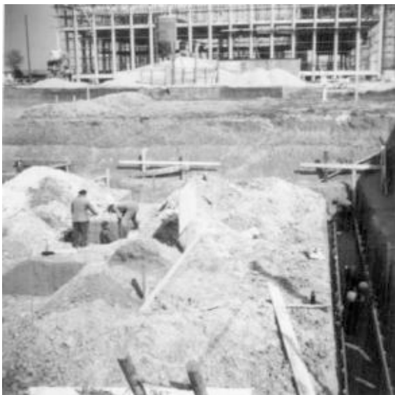
III. 407 « AFBA ». Début du chantier, travaux de terrassement pour les fondations. A l'arrière-plan on distingue l'ossature de béton armé du « CRAC » en cours de construction. Daté au verso 21 avril 1959. ALB_40.2.
