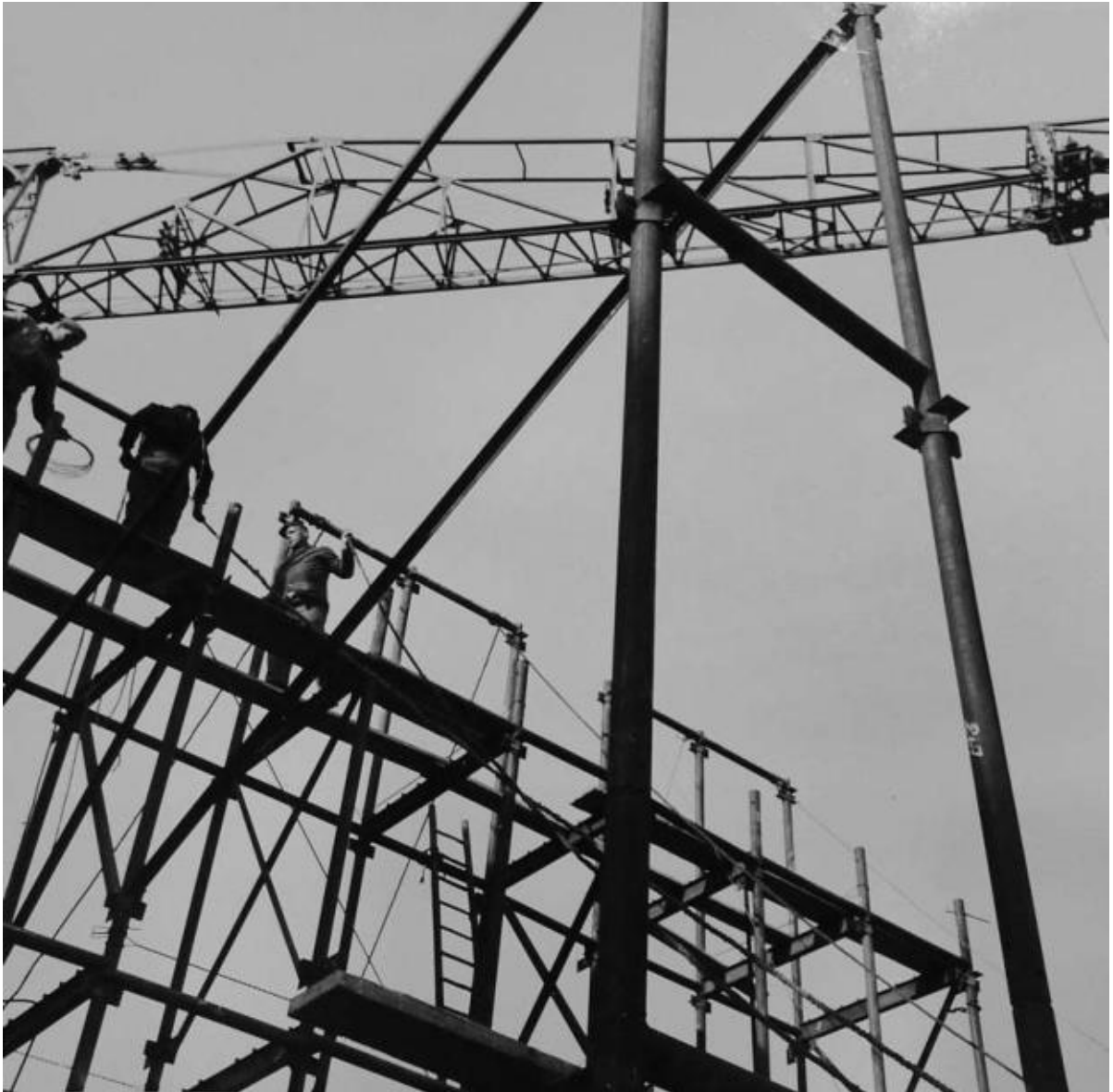
III. 255 Bureaux de l'Épargne de France 85, rue Jouffroy dans le XVII e arrondissement de Paris. Mise en place des « échelles » tubulaires composant la structure, [1955]. ALB_30.1.
