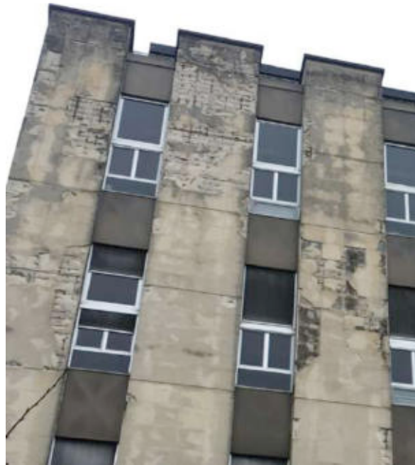
Ill. 837 Cliché de l'auteur, février 2019. Le placage de pierre semble plus fragile que les panneaux en aluminium envisagés par Édouard Albert.
