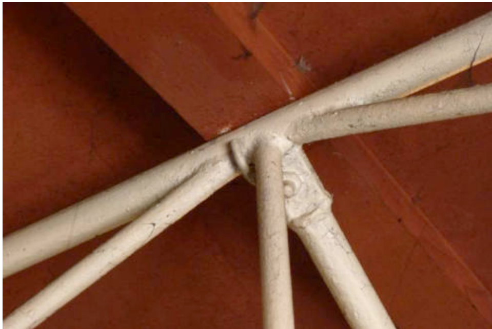
Ill. 642 Nœud de structure de la charpente comportant des éléments boulonnés et d'autres soudés en usine. Détail du raccordement de la charpente en bois à la structure métallique. Cliché de l'auteur, août 2013.
