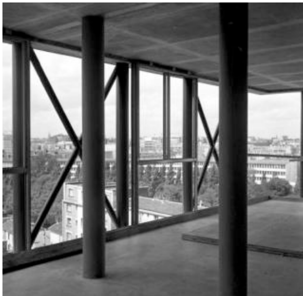
Ill. 369 Angle sud-ouest de la tour au-dessus du 6 e étage. Seuls les tubes des files de refend contraignent l'aménagement des appartements. Photographie prise lors du chantier, sans date [1960]. ALB_35
