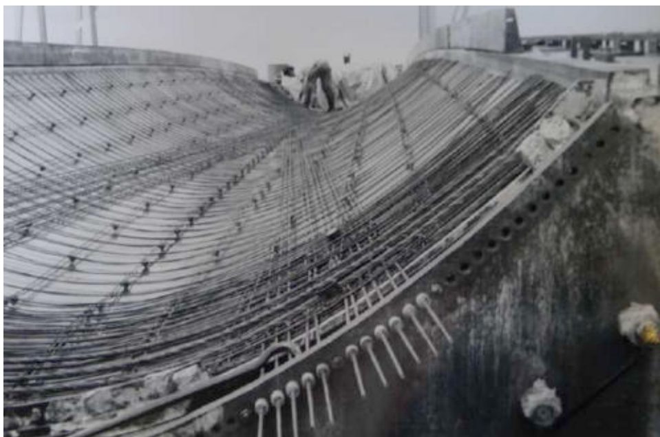
III. 904 Coque en béton armé précontraint réalisé par la « Société d'exploitation des procédés de construction Silberkuhl ». ALB_50.2.
