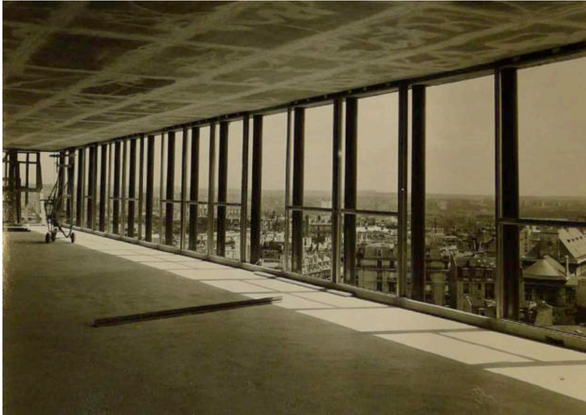
Ill. 368 En dehors des files de refend, les plateaux paraissent tels de vastes plans libres. Photographie prise lors du chantier, sans date [1960]. ALB_35.
