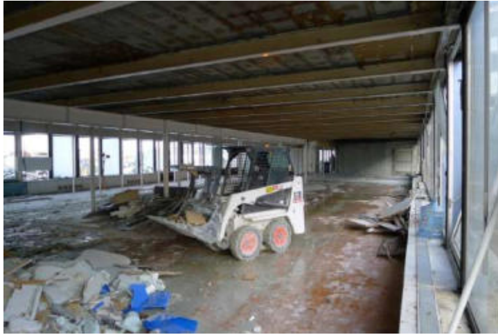
Ill. 623 La destruction des cloisons surajoutées fait réapparaître le vaste plan libre de la salle du restaurant, seulement traversé de quelques colonnes. Cliché de l'auteur, novembre 2013.
