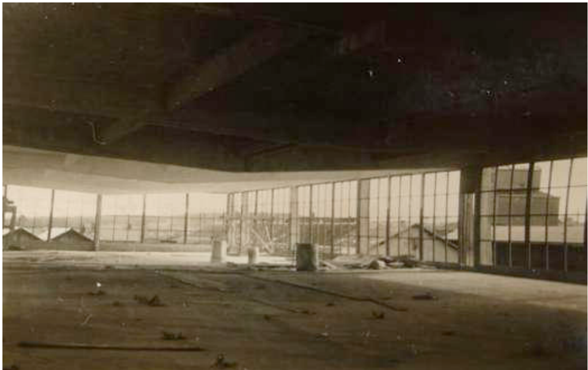
III. 67 « Usine métallurgique » Grosdemouge. Plan libre du R+1 avec poutres en « ventre de poisson », de 20 mètres de portée. Sans date [vers 1939]. ALB_13.
