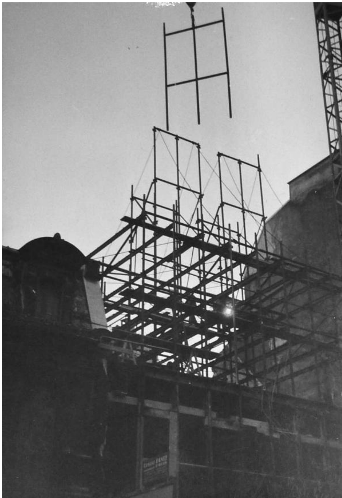
III. 254 Mise en place d'un portique de la façade principale. On remarque les contreventements provisoires et les échafaudages destinés à stabiliser la structure durant son montage, 1955. ALB_30.5.
