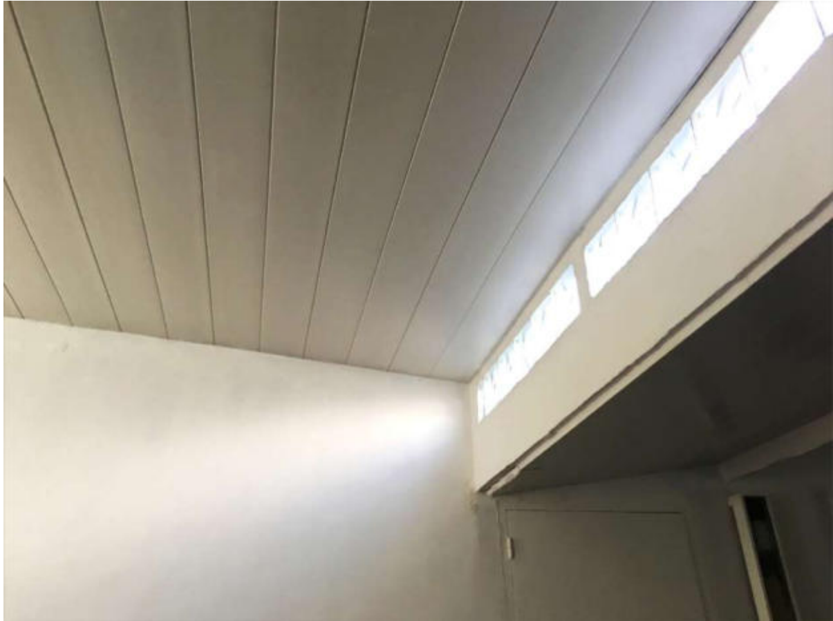
Ill. 134 Maison « Minimax » de Verneuil-sur-Seine. Décalage des pans de toiture, caractéristique de la maison « Minimax ». Le gain de lumière est évident, mais l'étanchéité à la jonction demeure un problème. État en 2017, photographie de l'auteur.
