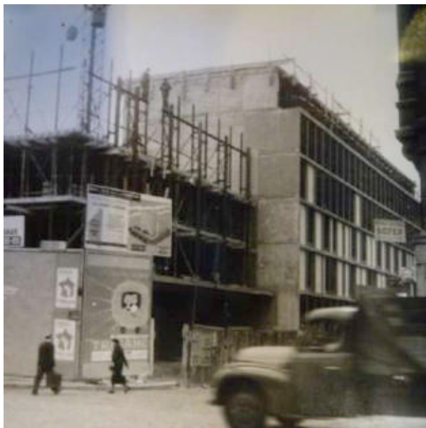
Ill. 488 « Immeuble 63-65, avenue Parmentier », vue du chantier depuis l'avenue Parmentier. La structure du petit immeuble passage Beslay est achevée. Sans date. ALB_47.2.
