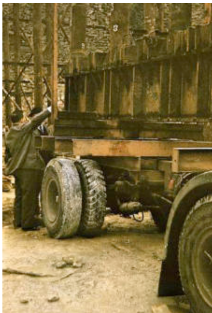
III. 287 Un camion amenant une poutre métallique préfabriquée sur le chantier du « Gratte-ciel n°1 ». Cliché d'Édouard Guhl. Sans date [1959]. ALB_35.
