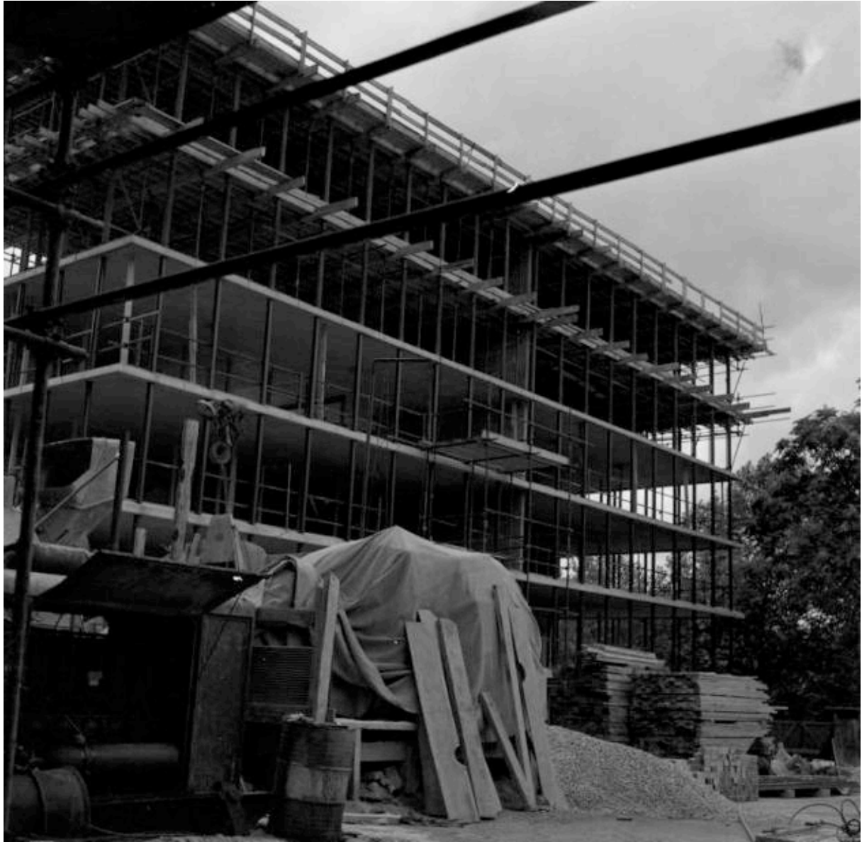
III. 294 Ossature métallique et planchers en béton armé du bâtiment sur rue de six niveaux. Sans date [1960]. ALB_35.
