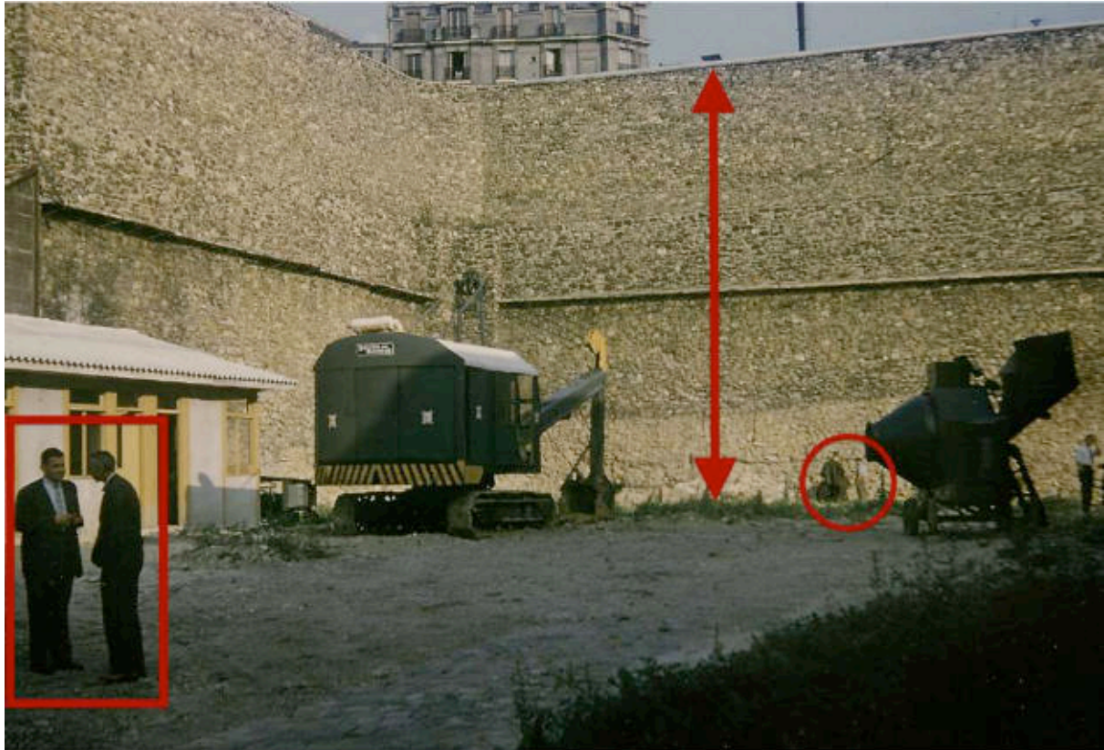
III. 298 Parcelle au numéro 33 de la rue Croulebarbe, sans date [1958]. On distingue, sur la gauche, Édouard Albert et Jean-Louis Sarf en pleine conversation. Ils sont photographiés par Édouard Guhl, alors en charge du suivi du projet au sein du cabinet Albert. A l'arrière-plan, on aperçoit deux silhouettes qui donnent l'échelle du mur de soutènement des ateliers de la RAPT, haut de 15 mètres [Cf. Plan d'exécution n°9, DOCAR_2003-115, Tube n°11]. Cliché conservé à la Bibliothèque Kandinsky en marge du fonds Édouard Albert, non coté.
