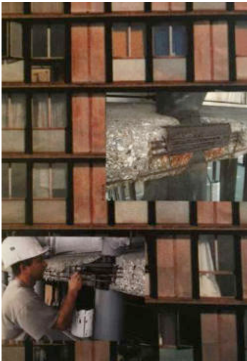
Ill. 598 Panneaux oxydés et éclats de béton au niveau des nez de dalles. Cliché publié in PIQUERAS Gorka, « Chantier, la restauration de la tour Albert », Architecture Mouvement Continuité , n° 155, octobre 2005, p. 26.
