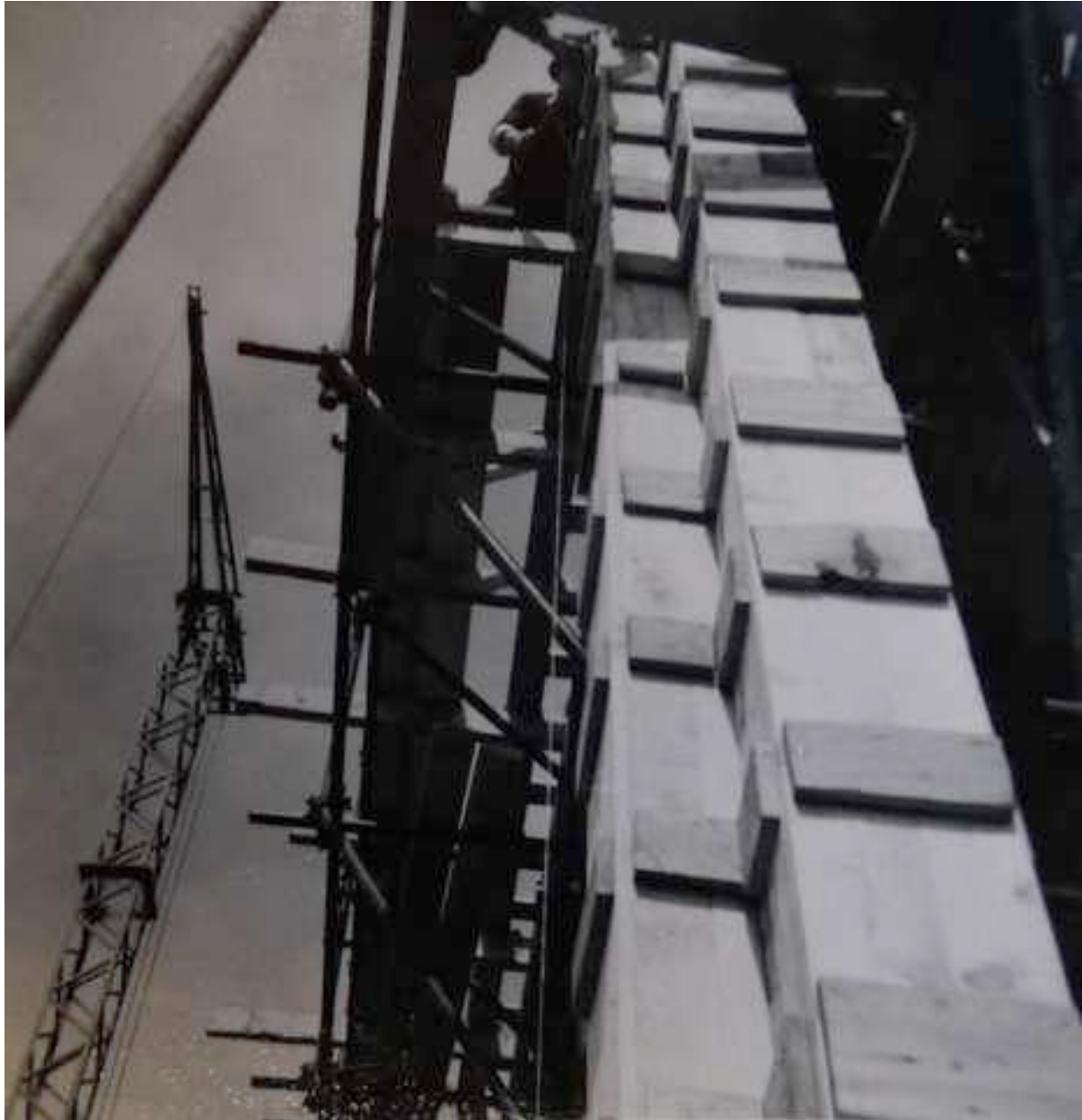
III. 220 « Centre d'émission d'Étampes ». Détail du coffrage en bois des angles « rentrants » du bâtiment. Sans date [1950]. ALB_24.2.
