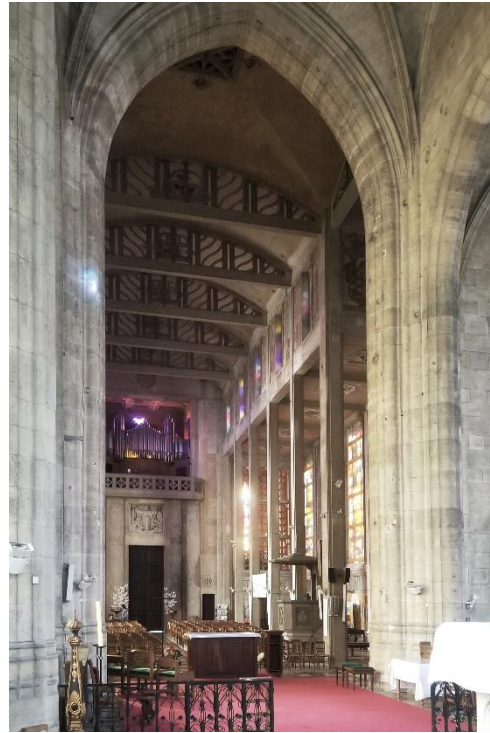
187 Saint-Pierre, Roye. Vue de la nef en béton armé depuis le chœur ancien. Photo: l'auteur, 2023.
