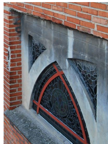
189 Noircissement du ciment armé dans une zone non soumise à la pluie. Saint-Jean de Montmartre. Baie sud-est. Photo : l'auteur, 2012.
