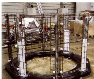
224 Plan du premier niveau du clocher et armatures de la tour centrale en atelier. Dessin et photo : Lionel Dubois ACMH.
