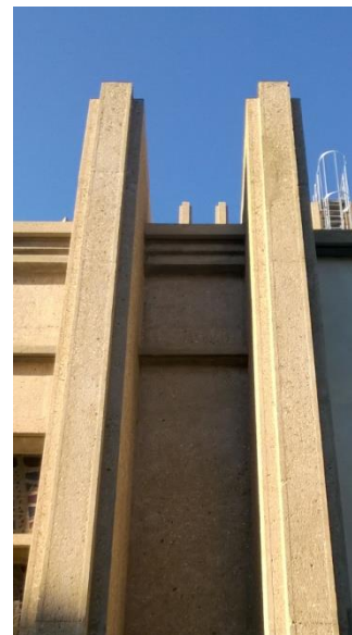
220 Façade sud. Vue de détail après les travaux de restauration Photo : l'auteur, 2018.
