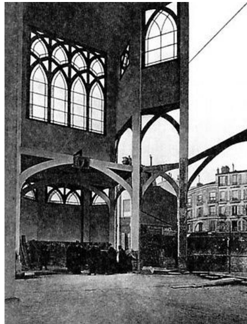
70 Photographie illustrant probablement l'inspection du Conseil des travaux de l'architecture sur le chantier de Saint-Jean de Montmartre, été 1900.
