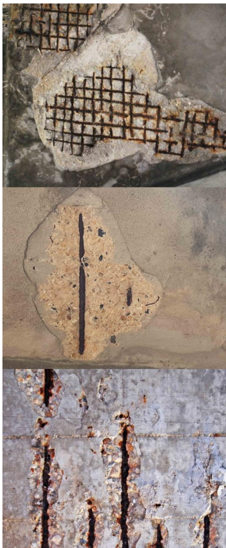
192 Corrosion avec éclat du béton en sous-face de dalle. Comparaison de trois cas. De haut en bas : Saint-Jean de Montmartre, Saint-Géry, Brie, Sainte-Thérèse, Montmagny. Photo : l'auteur.
