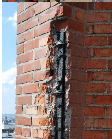
204 Désordres et réparations inadaptées. En haut : remplage d'origine doublé de béton armé dans les années 1930. En bas : pilier d'angle extérieur avec des traces de réparations successives (briques neuves et fausses briques en mortier). Photo : l'auteur, 2016.
