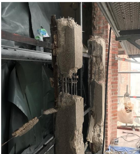
210 Démolition du remplage en ciment armé d'origine, doublé en béton armé banalisé dans les années 1930. Photo : 1090 architectes.
