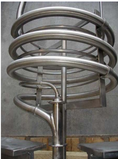
Figure 2-6 : Photographie du surchauffeur
