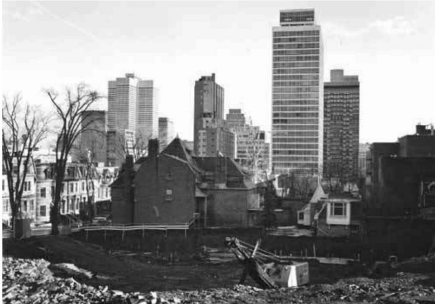
Fig. 11. Montréal, démolitions et excavations préalables à la construction d'une opération de logements, 1967. © Jeremy Taylor, DR.
