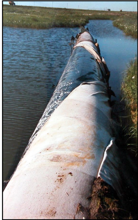
Un oléoduc mal/pas isolé a fait fondre le pergélisol et trempe, dans un bulbe de dégel, accélérant sa propre corrosion. Photo : © Y. Vaguet
