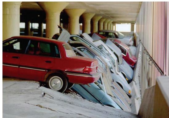
(b) Effondrement d'une dalle de parking, à cause de la corrosion causée par les sels de déverglaçage apportés par les voitures [57].
