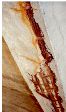
(a) Tablier de pont en bord de mer, dégradé par la corrosion liée aux sels marins [17].
