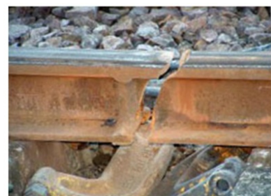
(c) Rupture d'un rail « pleine barre »
