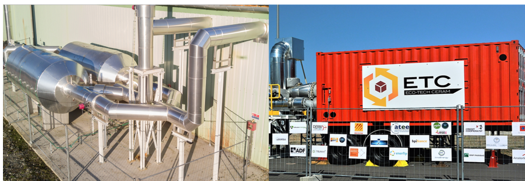
FIGURE 1.21 – Exemples de quelques installations de la technologie Eco-Stock® développées par le partenaire industriel de cette thèse Eco-Tech CERAM.
