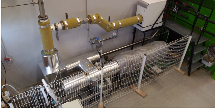
(a) Image réelle de l'installation Proto900 développée par Eco-Tech CERAM.
