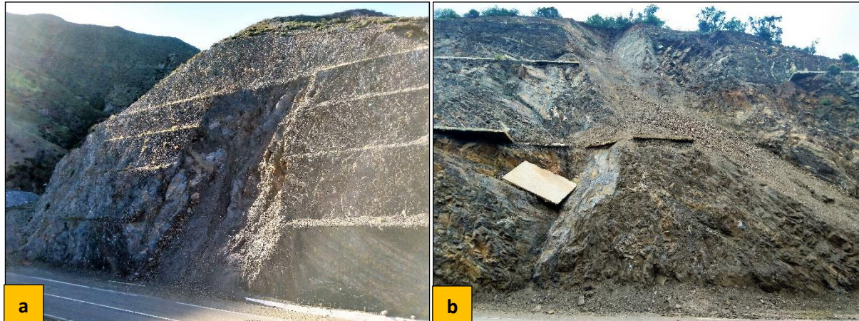
Photo 7 : Exemples d'effondrement des talus routiers de la RN 16. a) glissement du talus aménagé en escalier. b) glissement en dièdre au niveau d'un talus routier
