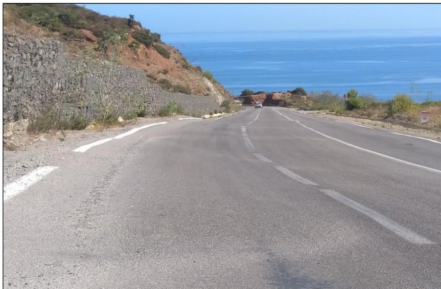
Photo 4 : Bombement de la RN 16 dû au phénomène de fluage
