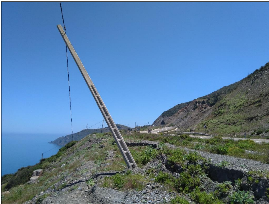
Photo 3 : Poteau électrique penché à cause du fluage du terrain (tête du talus)
