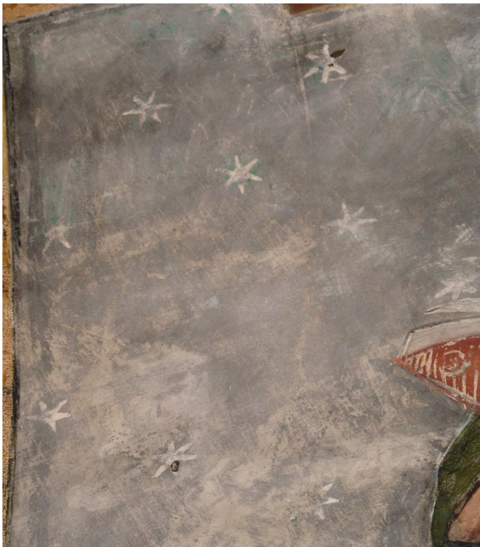
Figure 4 : Meyrals, XVI e s. Détail de la peinture de la voûte montrant le négatif d'un semi d'étoiles dorées selon la technique du zwishgold (or sur argent sur cire), aujourd'hui quasi totalement disparues (une étoile mesure ~ 5cm 2 ).
