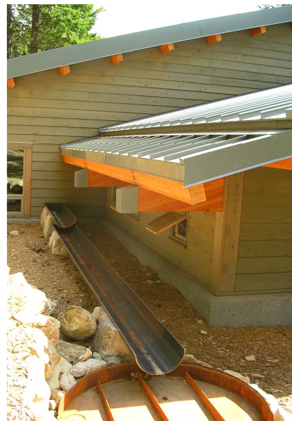
Photo. 28 : Système de récupération d'eau
