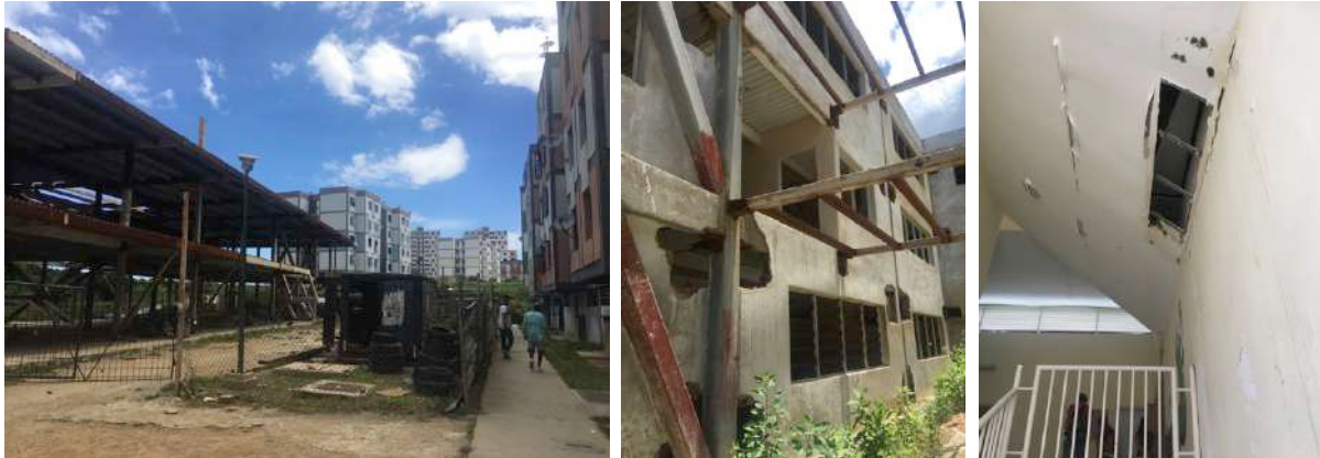
Image 117. Visites avec les techniciens 2017 Ciudad Caribia. Nous observons l'état d'infiltrations et d'abandon. ©yww, 2017
