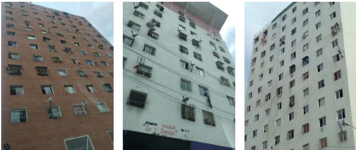
Image 122. Série d'images. Bâtiments GMVV, fait par l'OPPPE à la Municipalité Libertador et La Guaira. La brique rouge est un matériau couramment utilisé dans l'architecture vénézuélienne à laquelle nous sommes bien habitués en termes de perception de la matière, ainsi que de sensation de chaleur propre à la terre. Elle a généralement une vitesse de détérioration plus lente que le mur peint en blanc, qui se salit dès l'achèvement des travaux. © yww 2017-2019
