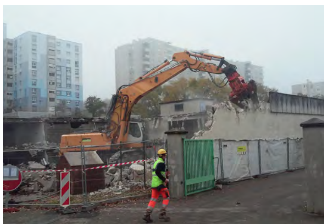
image 5 , ci-contre, démolition du parking souterrain derrière le centre commercial de la cité des Vernes, Givors, novembre 2014.
