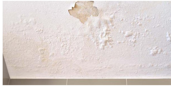
(b) décollement de peinture (source : maison et travaux.fr)
