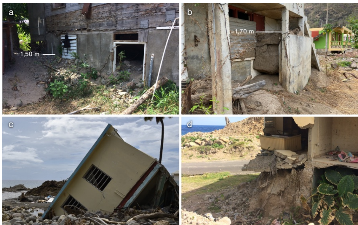
Figure 41 – Exemples d'endommagement par les aléas fluvio sédimentaires des aménagements en zone côtière. (a) Rez-de-chaussée d'un bâtiment à Colihaut enseveli sous les dépôts de crue après le passage de l'ouragan Maria. (b) Même phénomène visible à Coulibistrie dans une ruine. (c) Une habitation emportée par la crue de la Colihaut River après le passage de la tempête tropicale Erika. (d) Bâtiment partiellement emporté dans la crue de la Berekua Ravine, à Grand Bay. Photographies S. Battut, 2019, 2021 (a,b,d), Skerrit, 2015 (c), accessible à https://flic.kr/p/yBFozh .
