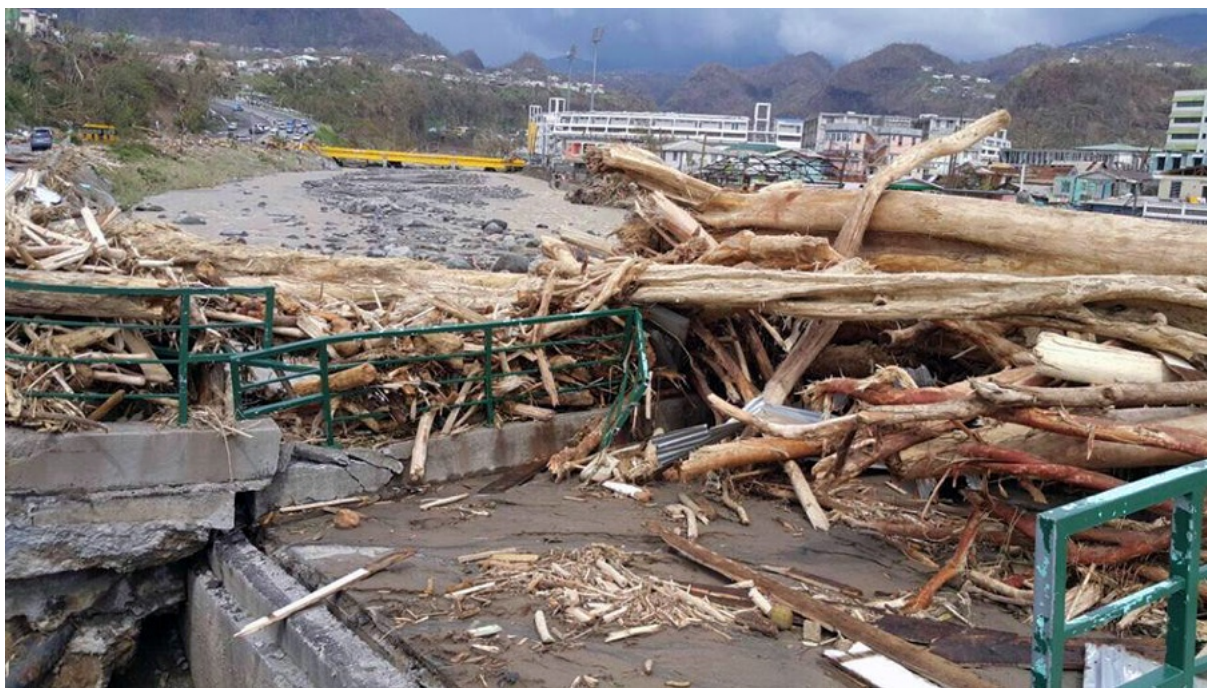
Figure 62 – L'E.C. Loblack Bridge à Roseau après le passage de l'ouragan Maria. Le lit du fleuve a été considérablement exhaussé par l'alluvionnement consécutif à la crue et les embâcles accumulés en amont du pont ont exacerbé son endommagement en perturbant les écoulements hydrauliques. Photographie de Chaune Fagan. Article du 25 juillet 2018 dans Caribbean Insight. Accessible à www.mycaribbeaninsight.com/hurricane-experience/ .
