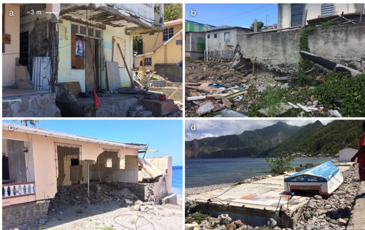
Figure 42 – Exemples d'endommagement par les aléas météo-marins des aménagements en zone côtière. (a) Rez-de-chaussée d'un bâtiment de front de mer à Scotts Head endommagé par la houle cyclonique de l'ouragan Maria. L'action abrasive des vagues a dénudé l'armature métallique de la structure en béton. (b) Affouillement par la houle d'un mur protégeant une habitation sur le front de mer à Mahaut. (c) Destruction partielle d'une habitation par la mer à Scotts Head. (d) Basculement d'une autre structure sur la plage de Scotts Head. Ici, le sens de basculement des armatures métalliques rend compte de la direction et de l'énergie de la houle sur la structure dont il ne reste plus que les fondations. Photographies S. Battut (2019).
