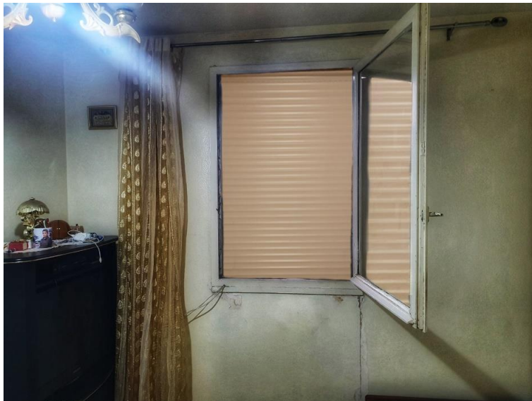
Figure 123 : Prise de photos de détails de la menuiserie et la persienne Aluminium. Source : Auteur, 2022
