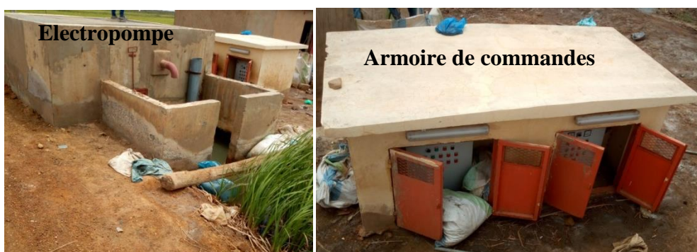
Photo 24 : Electropompe et armoire de commande des parcelles du 3PRD
