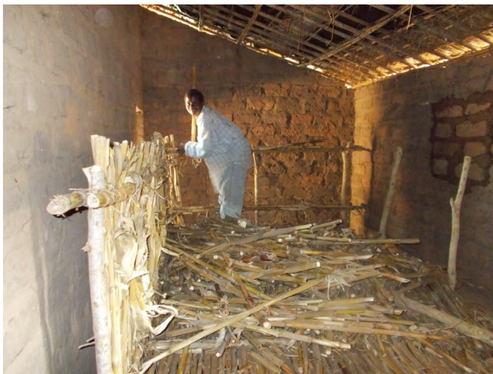
Figure 9.17 : Travailleur en train de construire un séchoir à maïs à l'intérieur d'une maison et non pas dehors comme traditionnellement. La construction d'un grenier intérieur permet de limiter les vols de récoltes.
