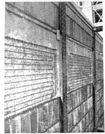
FIG. 1. — PANNeaux (SERPENTINS) POSÉS SUR LE COFFRAGE DU CIMENTER AVANT LA COULÉE DU BÉTON.
