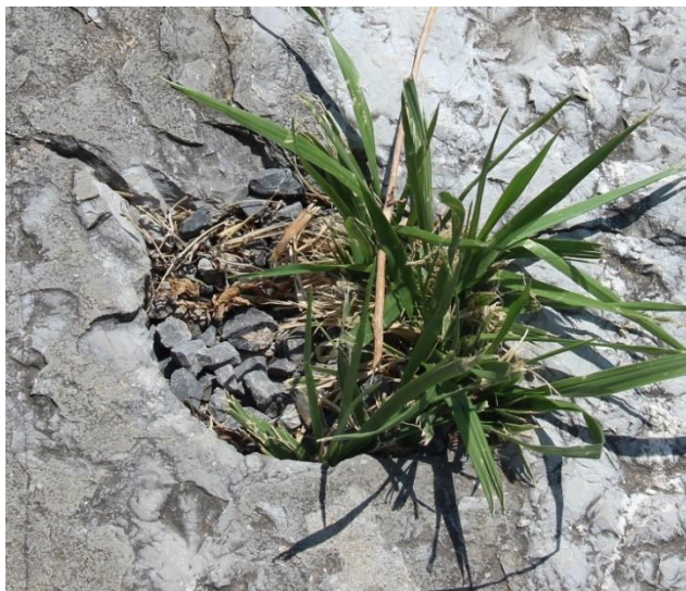
Figure 25 : Un des trous d'encastrement situé devant la loge d'honneur du stade de Messène (trou d'encastrement n° 3 sur la figure 27)
