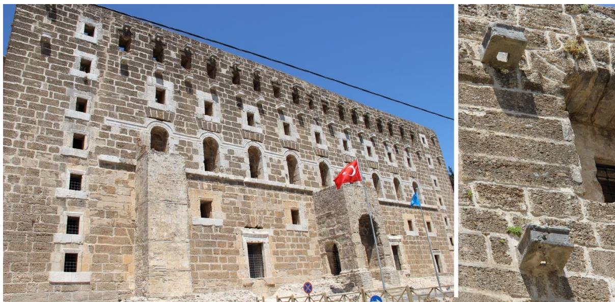
Figure 152 : Consoles situées derrière le mur de scène 97
