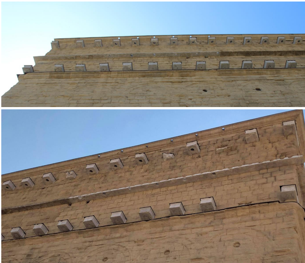
Figure 142 : Pierres de nature différente sur la corniche intermédiaire de l'extérieur du mur de scène du théâtre d'Orange
