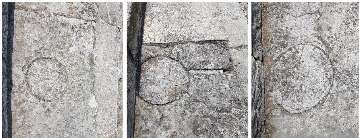
Figure 29 : Trous d'encastrement rebouchés lors de la restauration du théâtre d'Arles - exemplaires 1 à 3
