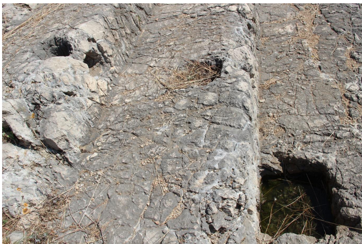
Figure 40 : Trou d'encastrement de grande section et deux trous débouchants sur le théâtre d'Argos
