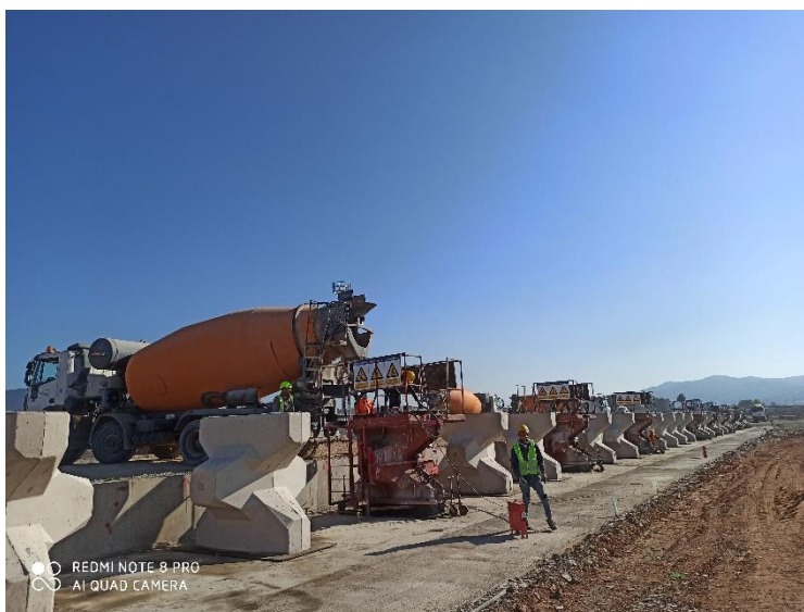
Figure 188. Préfabrication des unités Accropode sur le site de Skikda. (Source : Bilel Allili, 2021).
