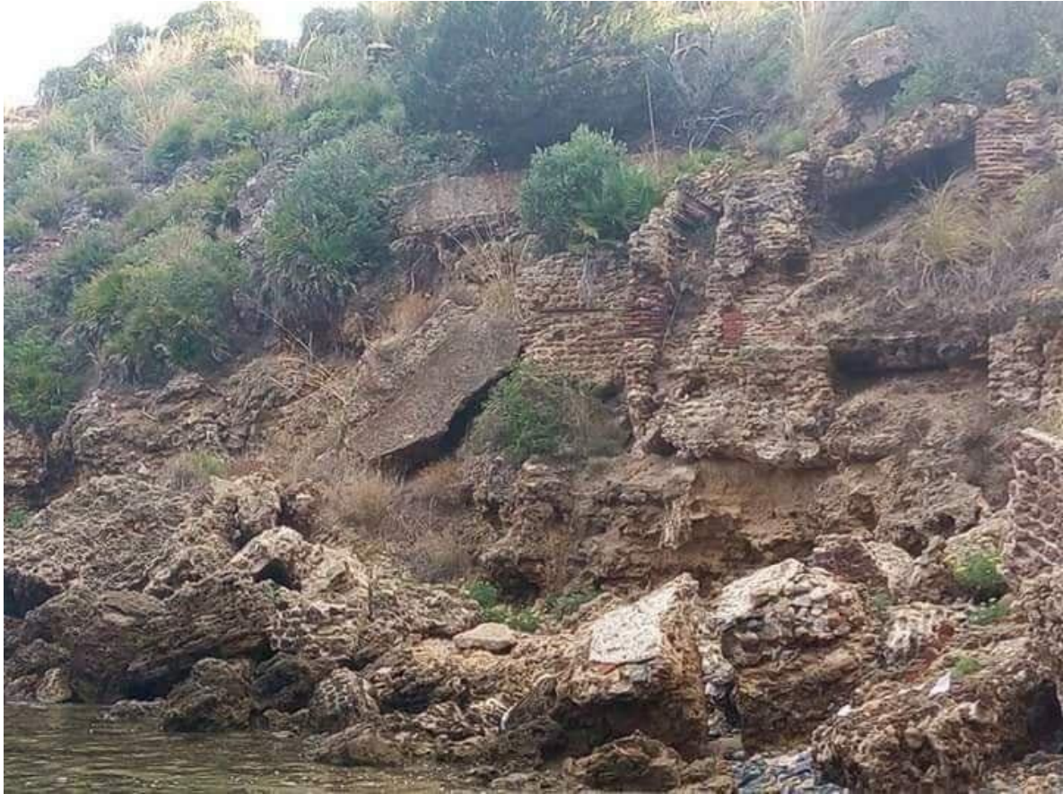
Figure 58. L'effondrement des traces antiques au port d'Oued Bibi et Tanji. (Source : Guide touristique Skikda, 2016).
