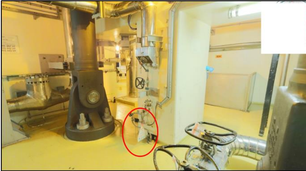
Figure 71. Point chaud derrière la vanne que les stagiaires doivent manipuler.
