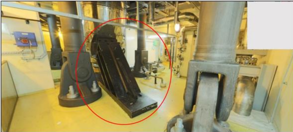
Figure 43. Cale antisismique (en noir) arrachée par la dilatation du tuyau.
