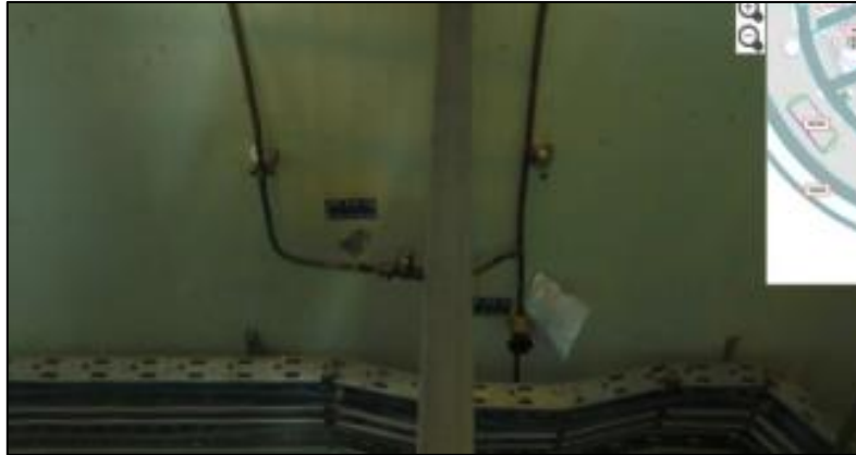
Figure 92. Tuyauterie sur laquelle était raccordée la vanne d'air (vanne cachée).
