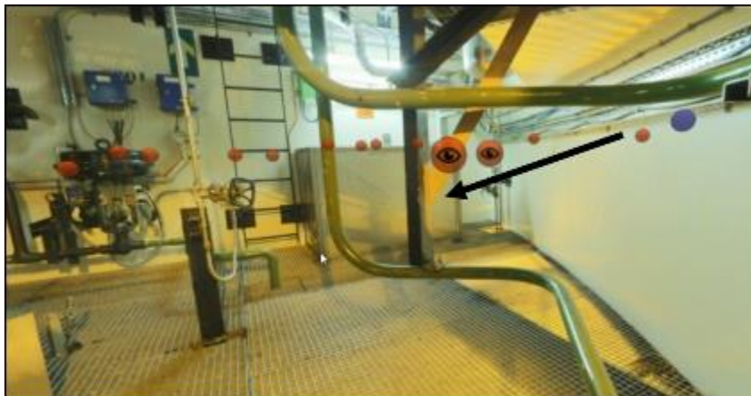
Figure 93. Plaquage derrière lequel se trouvent la vanne "cachée" et la vanne qu'ils ont vue.
