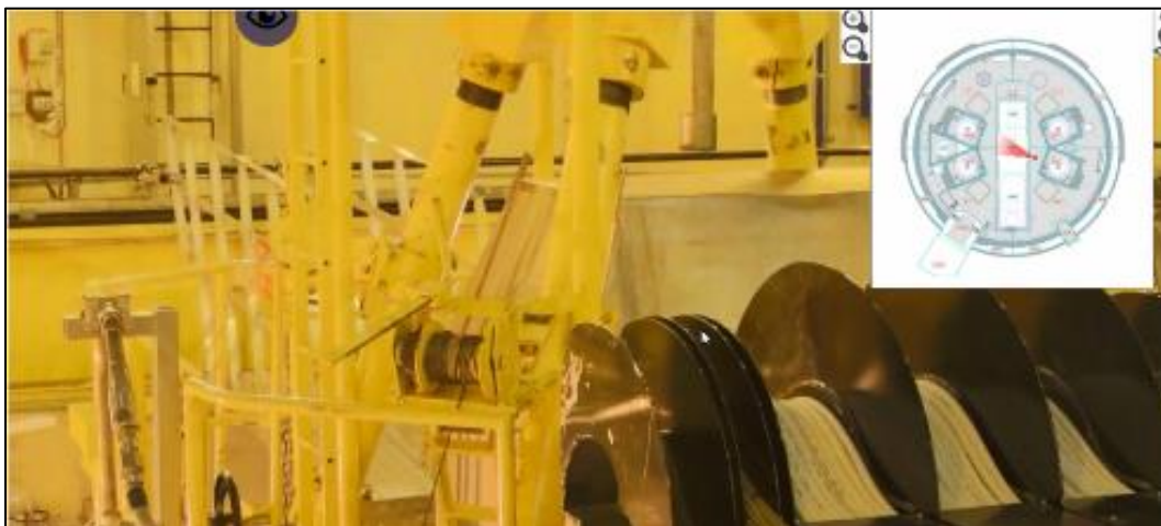
Figure 97. Filin, bobine et structure métallique jaune se trouvant au-dessus du couvercle de la cuve.
