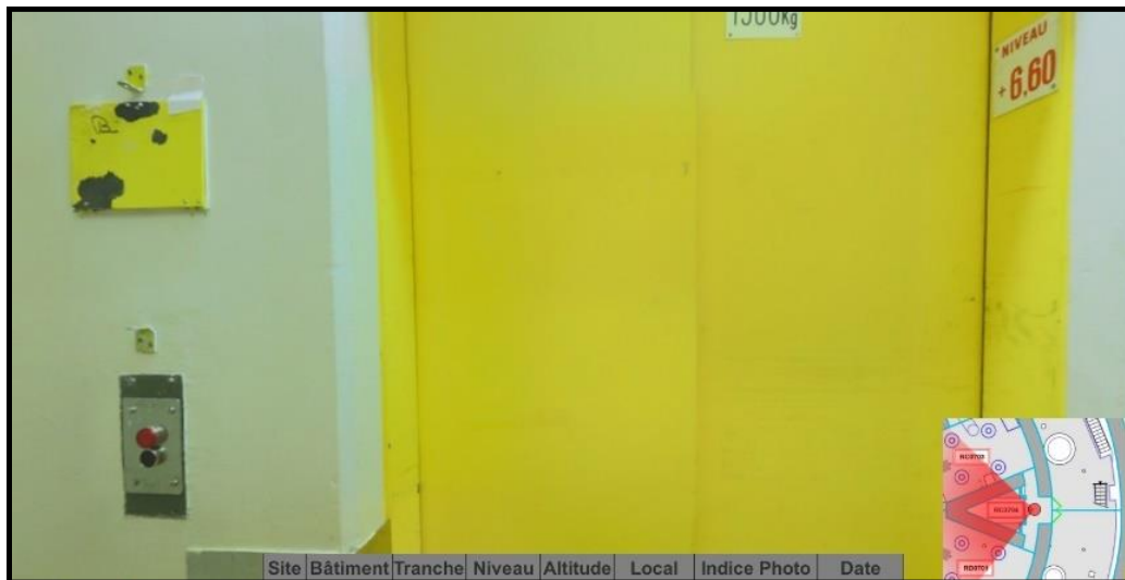
Figure 72. Capture d'écran de l'ascenseur avec la pancarte métallique à gauche qui indique l'interdiction de l'utiliser quand elle est dépliée.
