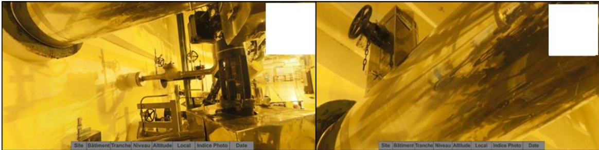
Figure 65. Conduite se trouvant dans le local voisin. À gauche vue de loin, à droite zoom pour lire le repère fonctionnel.
