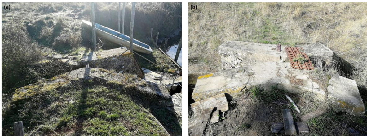
Figure 122 : Photographies des essailles (a) anciennes construites en pierre, (b) récentes construites en béton. (Photographie : Léa Paly, 2021)
