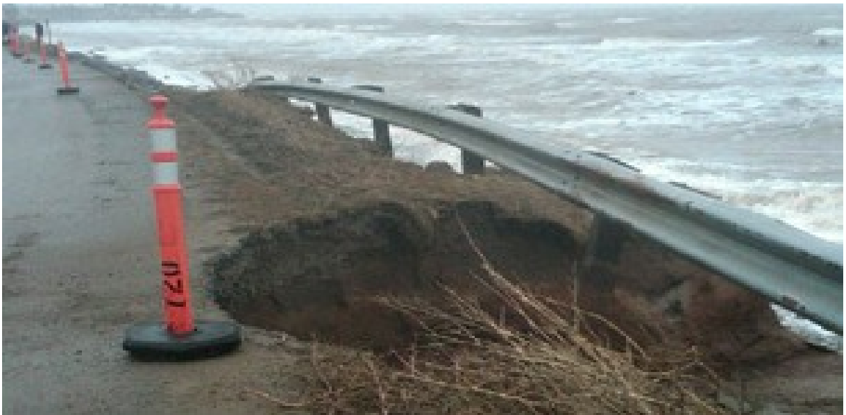
Photo 6 : Inondation d'une route à Grande-digue (décembre 2010) 32
