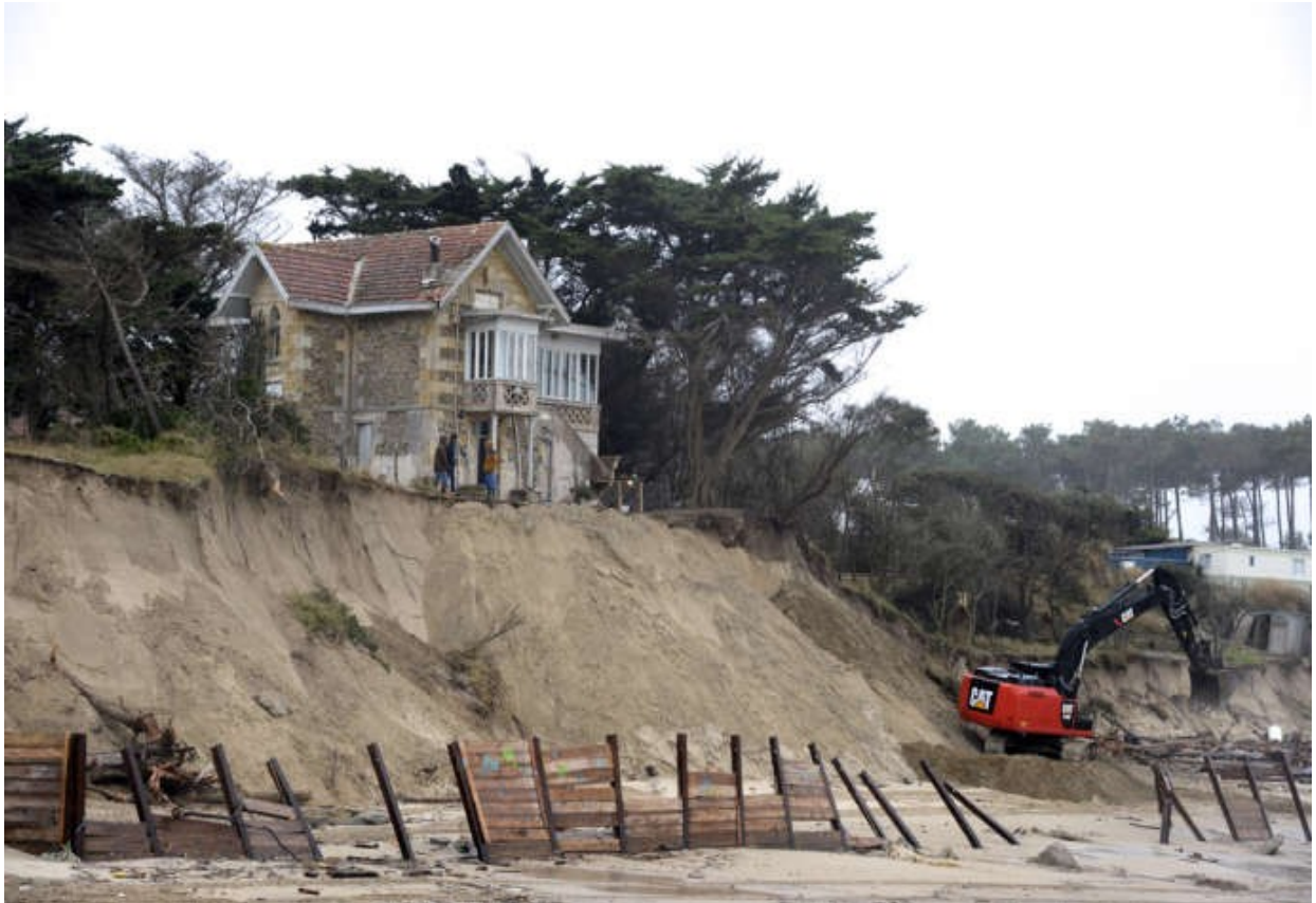
Photo 2 : érosion de la dune menaçant une habitation à Souillac-sur-Mer (janvier, 2014) 12
