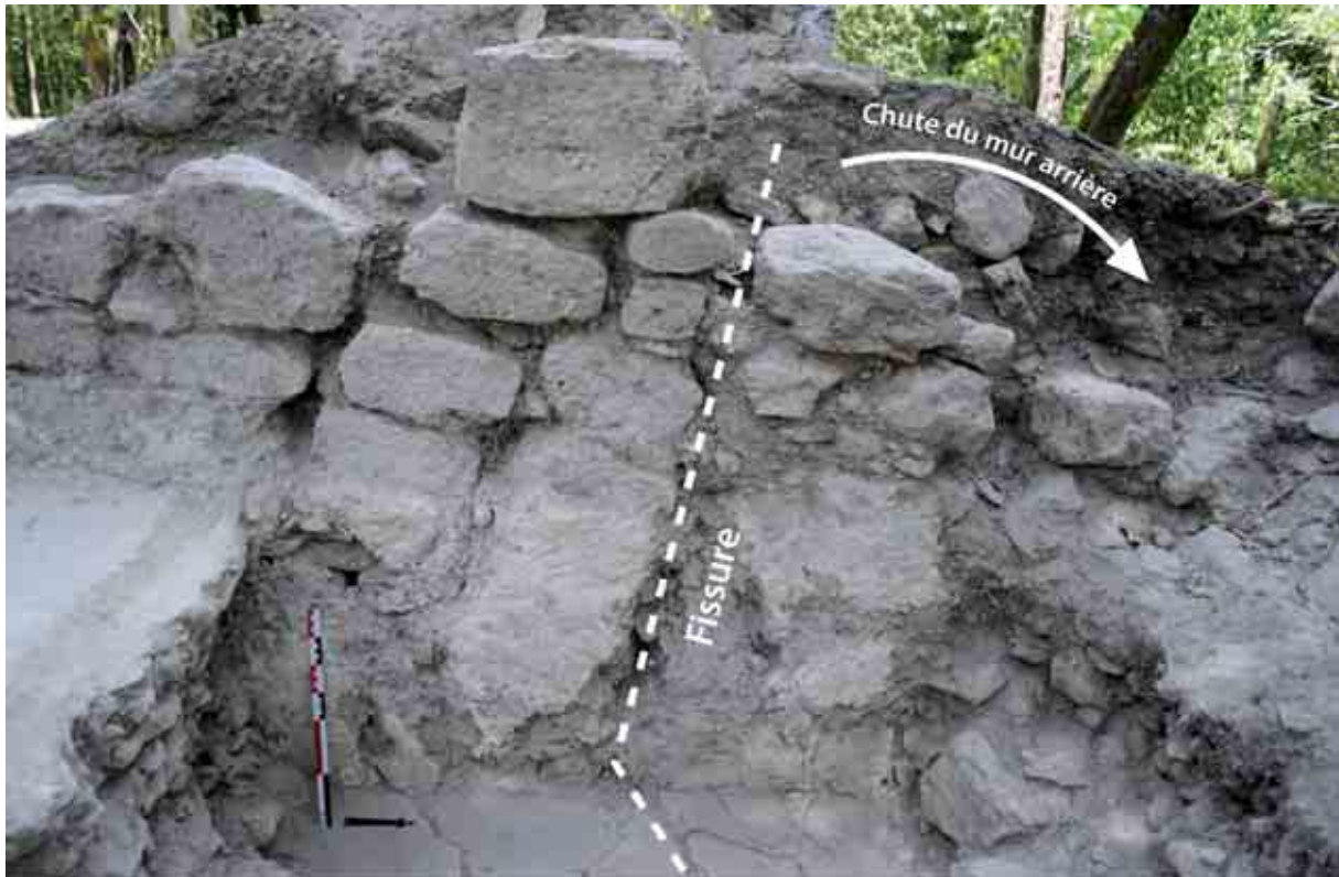
Fig.VI.32. Vue du mur commun entre 5N-6 et 5N-7, face à l'ouest. La « pièce rapportée » qu'est le mur arrière de 5N-7 n'a pas résisté au poids de la construction et chuté dans la pente, vers le nord.
