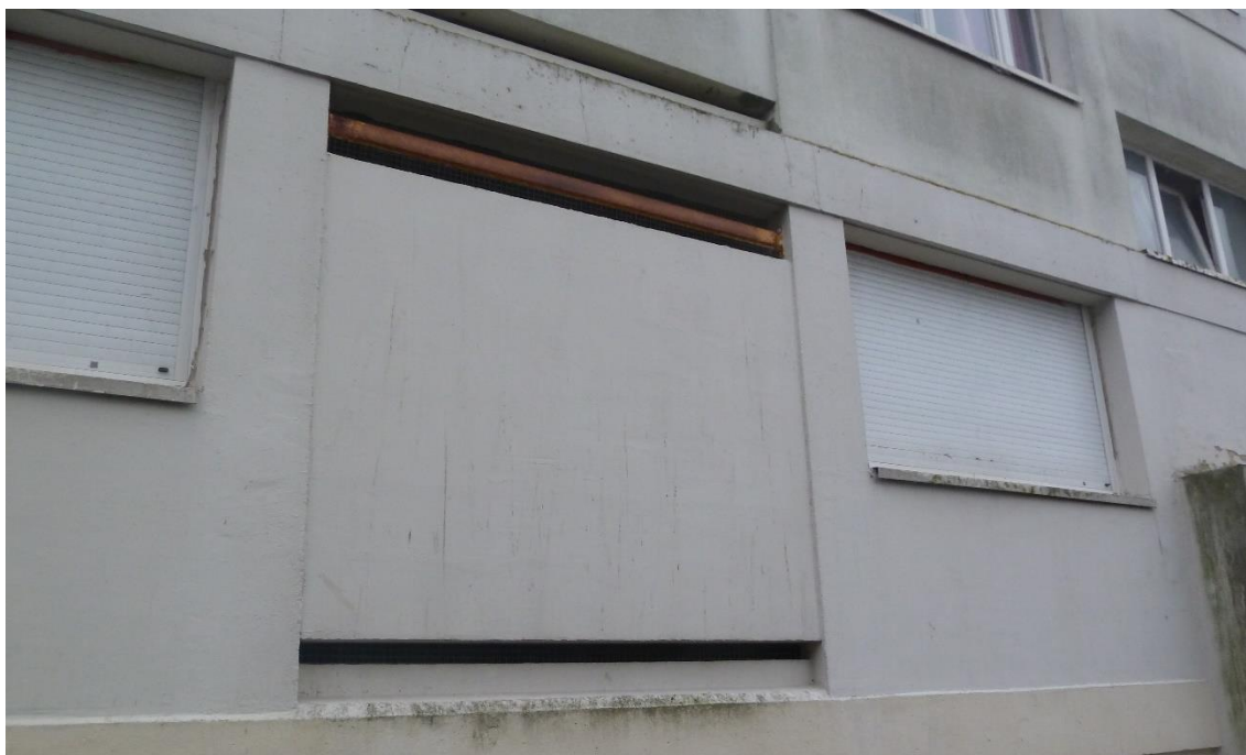
Figure 8-4 : Une mise hors marché à moindre coût, les pieds d'immeubles « tôleés »
