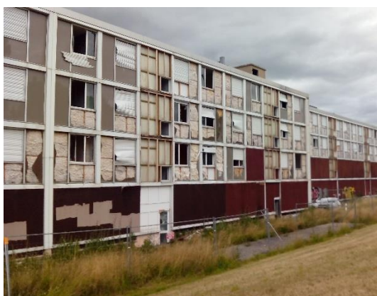
Immeubles en attente de démolition, en bordure d'une opération PNRU à Firminy Vert, Firminy, Loire
