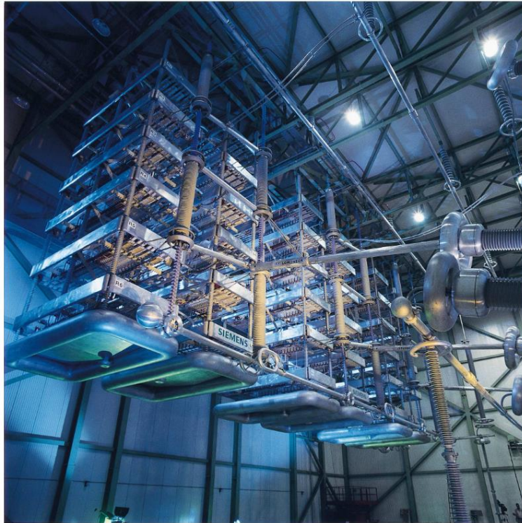
Figure 3. Valves à thyristors d'un convertisseur HVDC triphasé 500kV [12]
