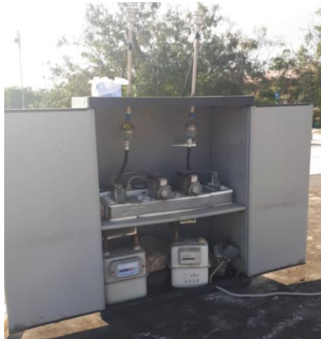
Figure 2.6 : Image des équipements installés sur le site A3, situé à Lycée Moderne de Korhogo de Treichville.
