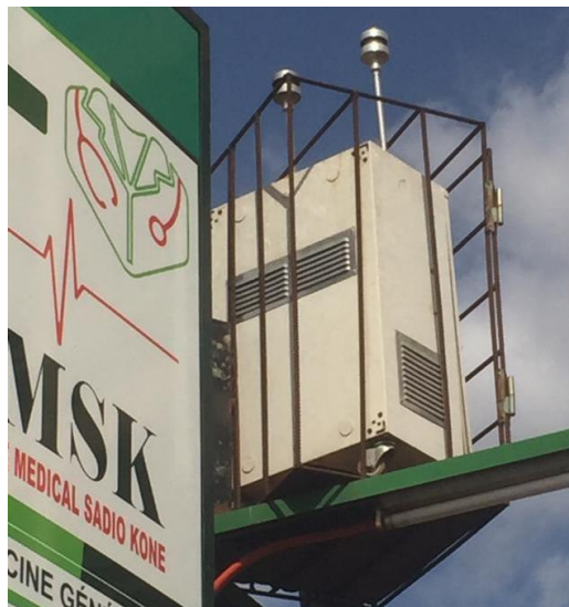
Figure 2.8 : Image de l'installation du site K2, situé à la Pharmacie du Nord de Korhogo.
