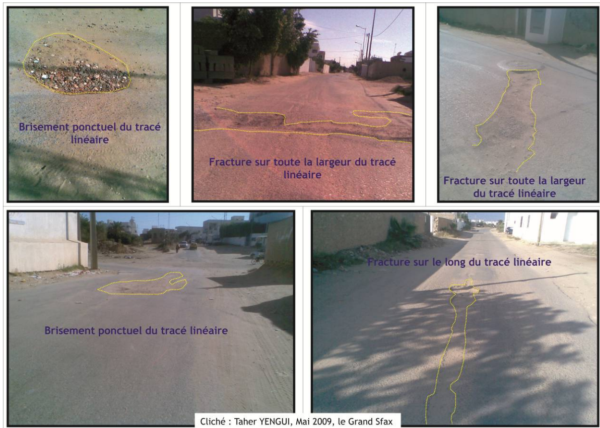
Photo 5 : Quelques formes de dégradation du réseau routier dans le Grand Sfax
