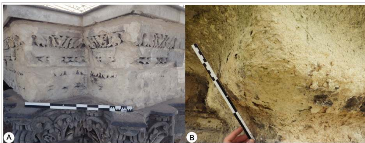
Figure III-66. Exemples de détachements de matières : A. : Désagrégation granulaire et B. : Desquamation en plaques
