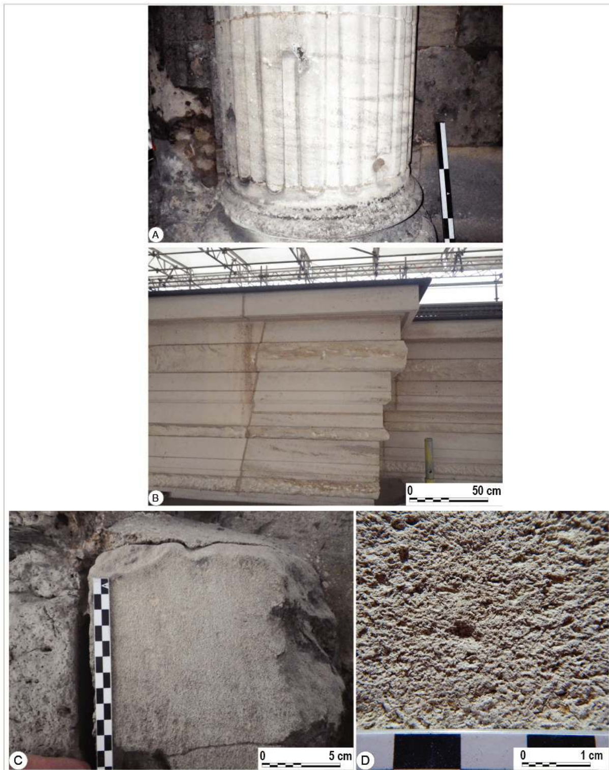
Figure III-49. Photographie du faciès type des calcaires à « oolithe vacuolaire » de type pierre de Savonnière. A ; Base de colonne restaurée au XIXe siècle ; B : Pseudo-attique de couverture construit en 2016 ; C : Moellon de restauration du XIXe siècle ; D : Aperçu macroscopique des calcaires oolithiques.
