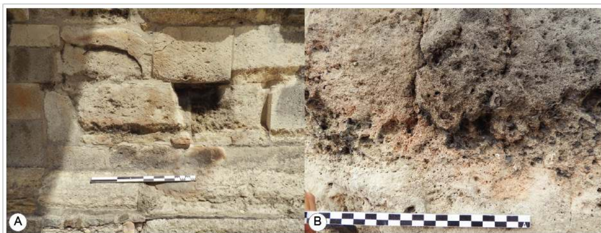
Figure III-70. Traces de rubéfiations, rougissements des surfaces et désagréations de la pierre en lien avec une exposition à de hautes températures
