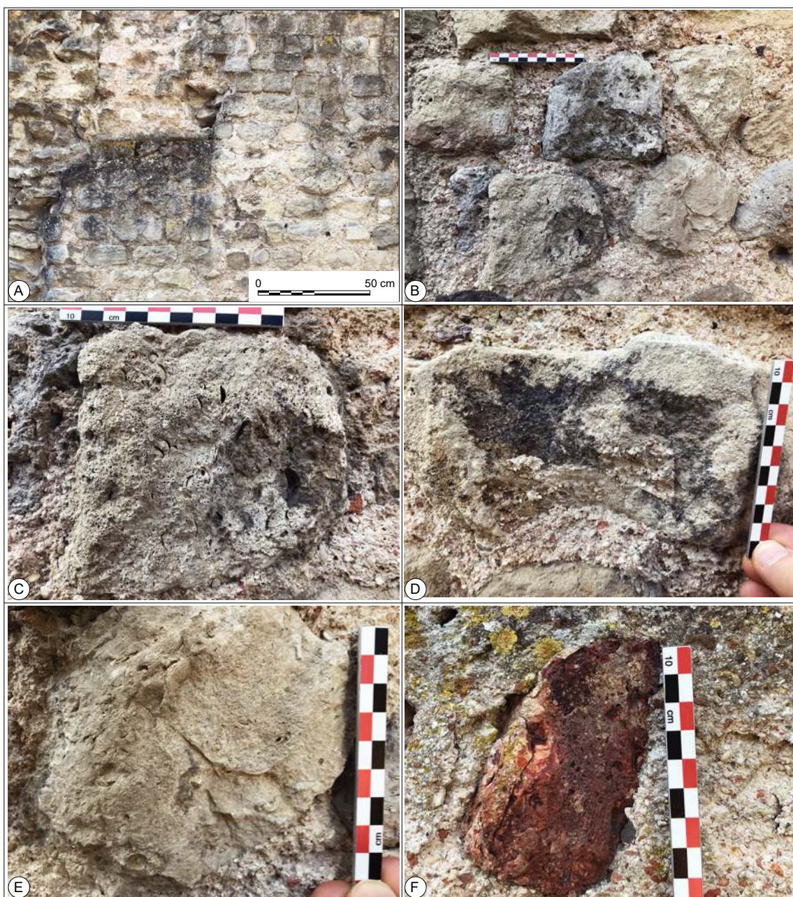
Figure II-47. Aperçu des modalités d'assemblage des maçonneries et des faciès les plus représentés dans les moellons des élévations du Cryptoportique (mur de la Façade Est du bâtiment). A et B. Assemblage en petit appareil des élévations du monument ; C. Calcaire massif à nombreux Ditrupa et lamellibranches ; D. Calcaire massifs à Ditrupa et gros grains de quartz ; E. Moellon de grès quartzite gris F. Moellon de pierre meulière (sa couleur très rouge découle d'une exposition au feu).
