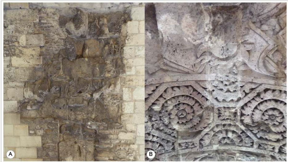
Figure III-73. Exemples d'encrassements des parois du bâtiment. A. : dépôts de particules noires sur toutes les surfaces protégées des intempéries ; B. Encrassement des voûtes mis en avant par contraste avec une petite zone ayant fait l'objet d'un test de nettoyage des surfaces.
