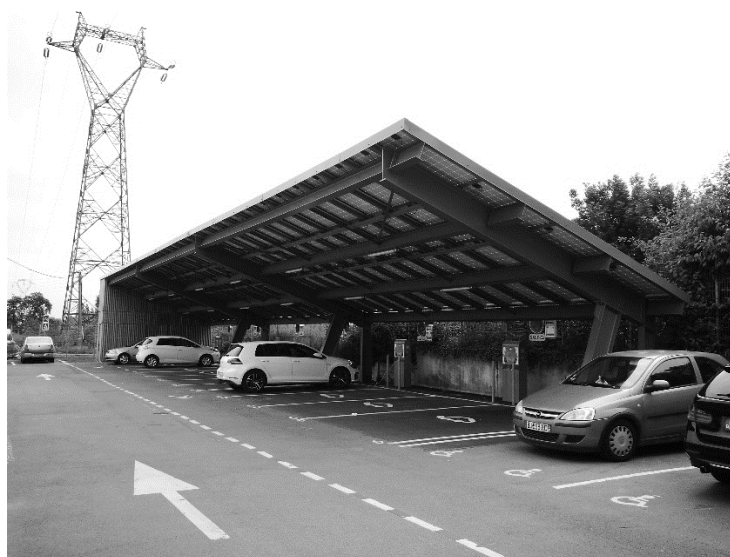
Figure 62 : Ombrière photovoltaïque à Lomme.
