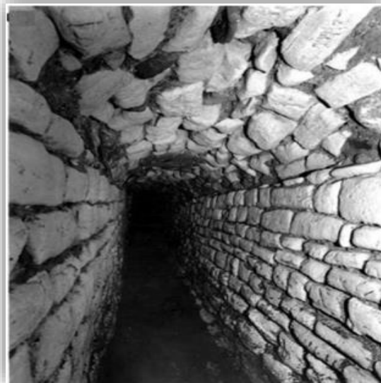
Figure 4. Égout romain (à Narbonne), d'une largeur de 0.70 m, sur 72 m de long, et une hauteur variant entre 1.30 et 1.80 m. Source : Dellong et al. , 2003
