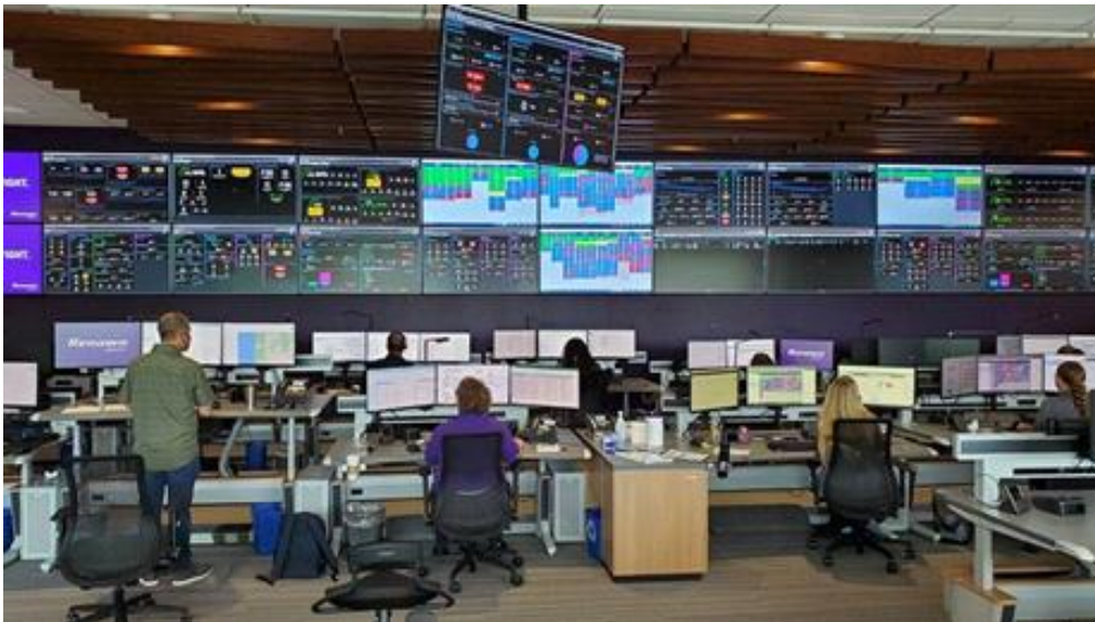
Figure 49. Centre de commande du John Hopkins Hospital à Baltimore
