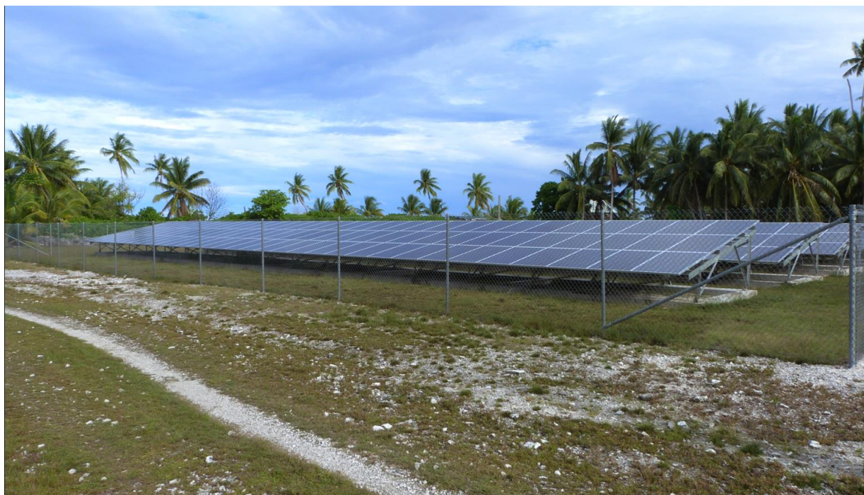
Figure 12 - Station solaire du village de Tauhunu à Manihiki (photo D. Glory, 2017)
