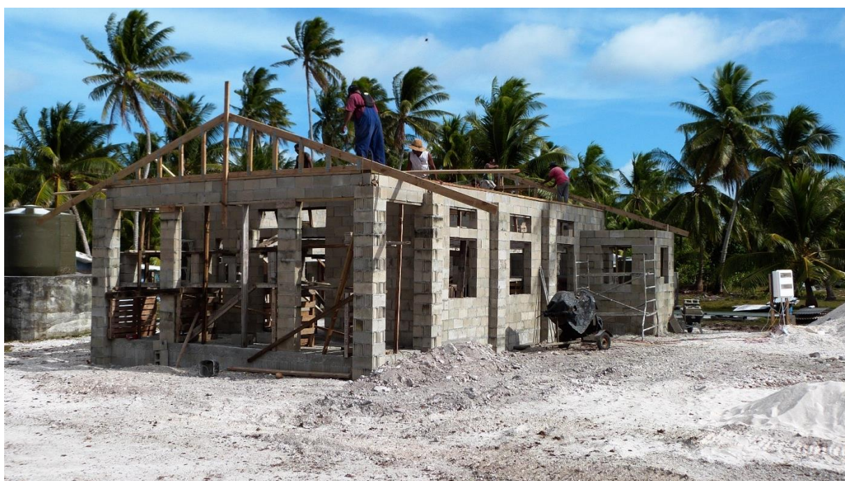
Figure 41 - Chantier de reconstruction de l'Église du septième jour à Tauhunu - Manihiki (photo D. Glory, 2018)
