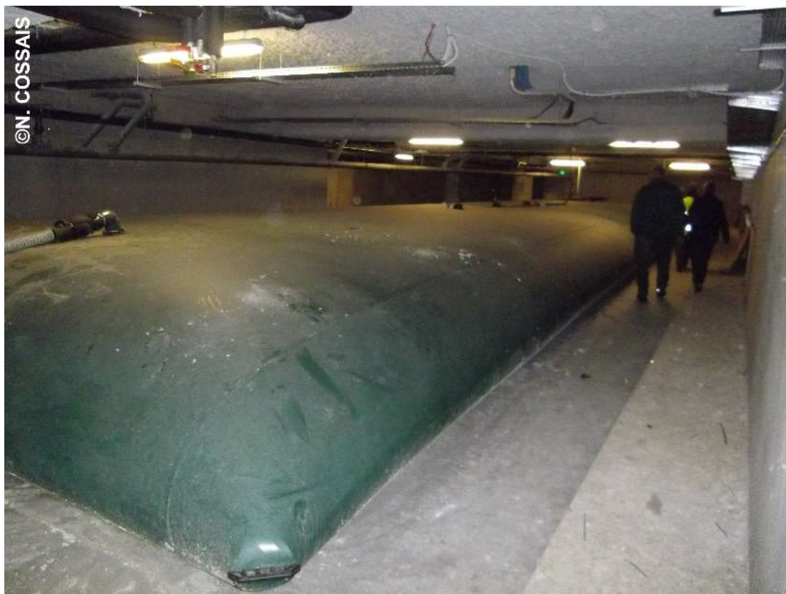
Figure 40 : Dispositif de gestion des eaux pluviales du parc Jacob Kaplan dans le 3 ème arrondissement de Lyon. Bâche de stockage des eaux pluviales, mai 2016.
