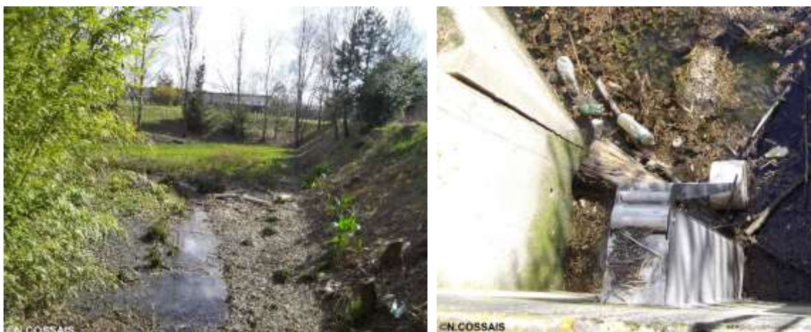
Figure 118 : À gauche, déchets verts laissés sur place suite à l'élagage réalisé par une entreprise. À droite, régulateur de débit bloqué par les végétaux, sans accès direct possible. Photographies du 10 mars 2016.
