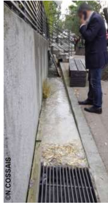
Figure 28 : Amas de feuilles gênant l'évacuation de l'eau. Quartier de la Confluence à Lyon, le 9 juin 2016.
