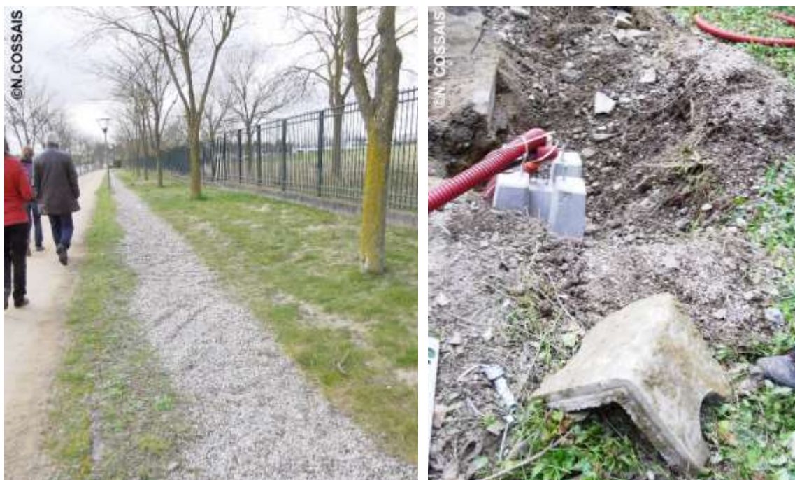
Figure 46 : Lampadaires construits dans une tranchée d'infiltration du Parc technologique de la Porte des Alpes, Saint-Priest. À gauche : tranchée d'infiltration et lampadaire au loin. À droite : massif de fondation d'un lampadaire mis en œuvre à la place d'un regard de la tranchée. Photographie du 27 mars 2015.
