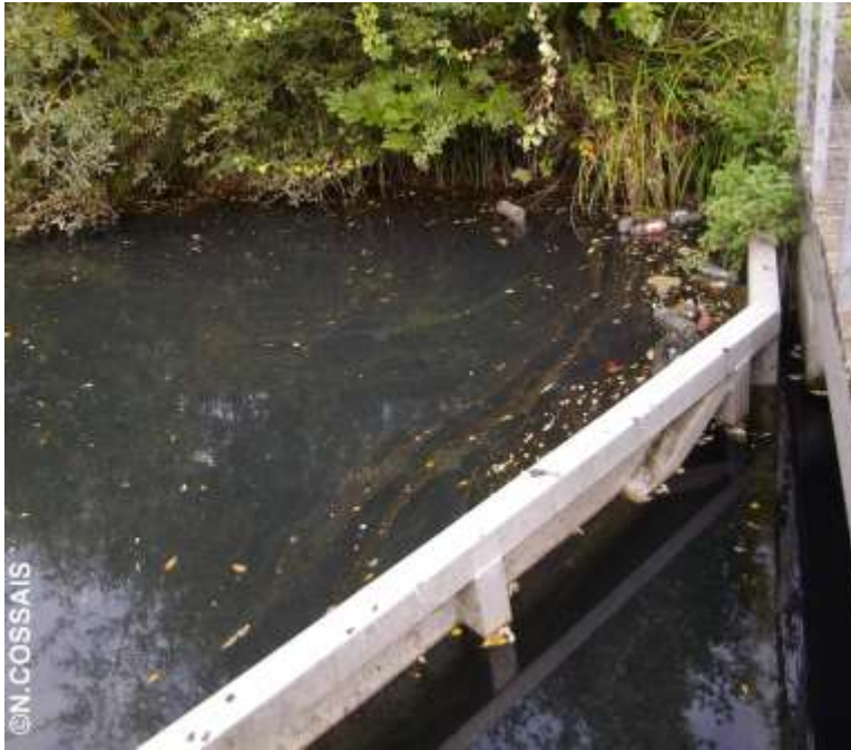
Figure 27 : Dépôts à la surface de l'eau, Quartier Bottière Chesnaie à Nantes. Photographie du 13 octobre 2016.
